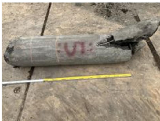
折損部の杭体の様子
