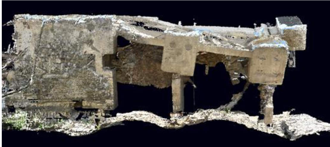
(d) 建築物底面 (転倒により露出した部分の敷地西側からの画像)
