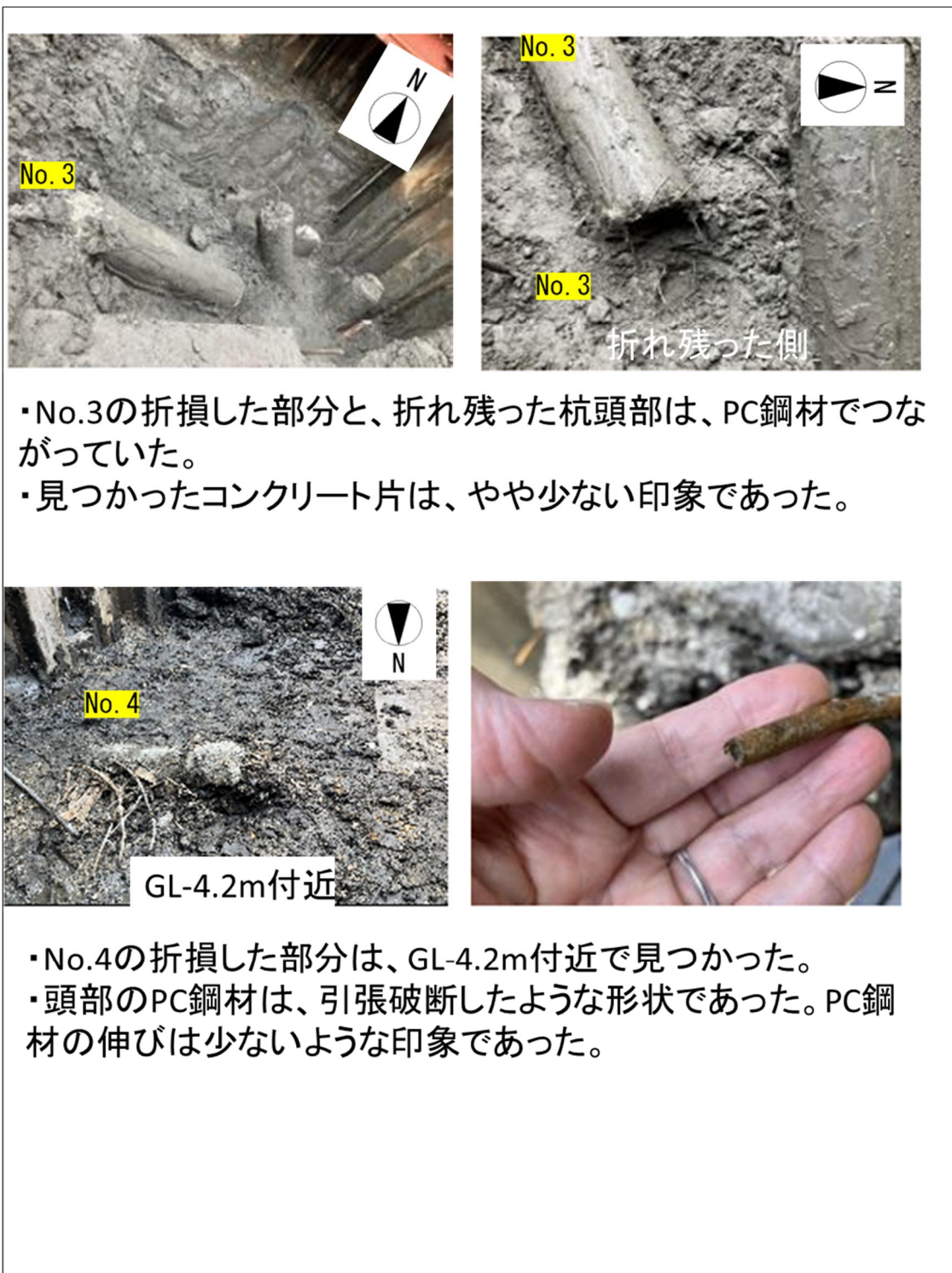
図 3.1.4-20 杭頭部付近の損傷状態 (X2Y3 その3)
