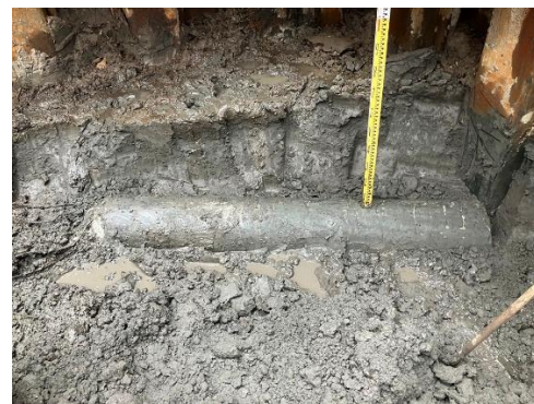
(b) 折損した杭 (G. L. -4.2m 付近)
