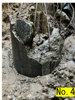
図 3.1.4-7 杭頭部付近の損傷状態 (X0Y0)
