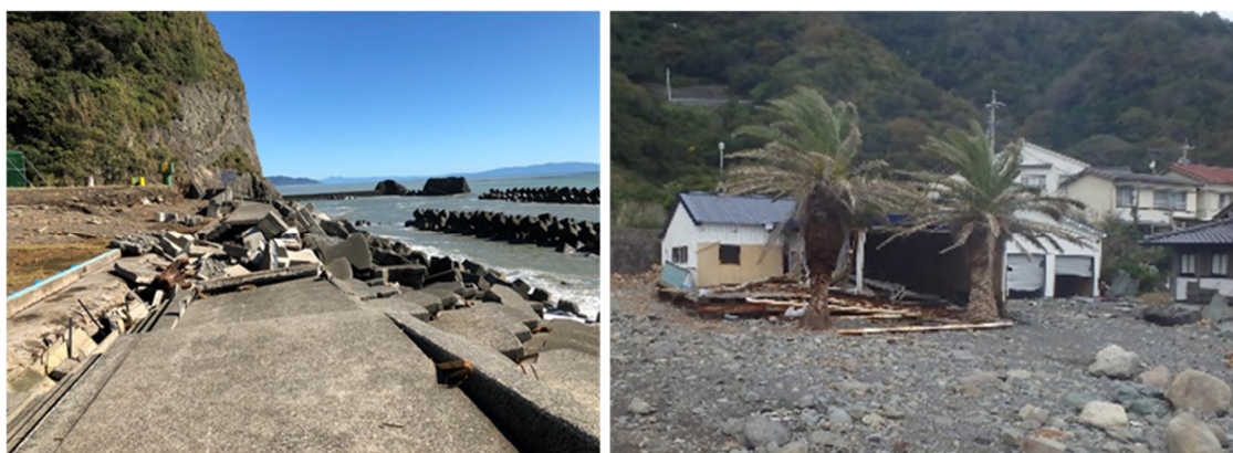
写真-3.2.2.4 焼津大崩海岸での越波被害状況（静岡県提供）
