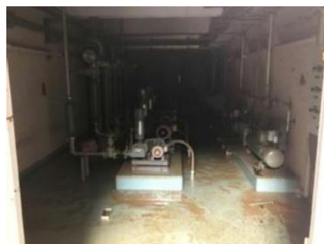
写真1-1-4 流入処理棟ブロワ室
