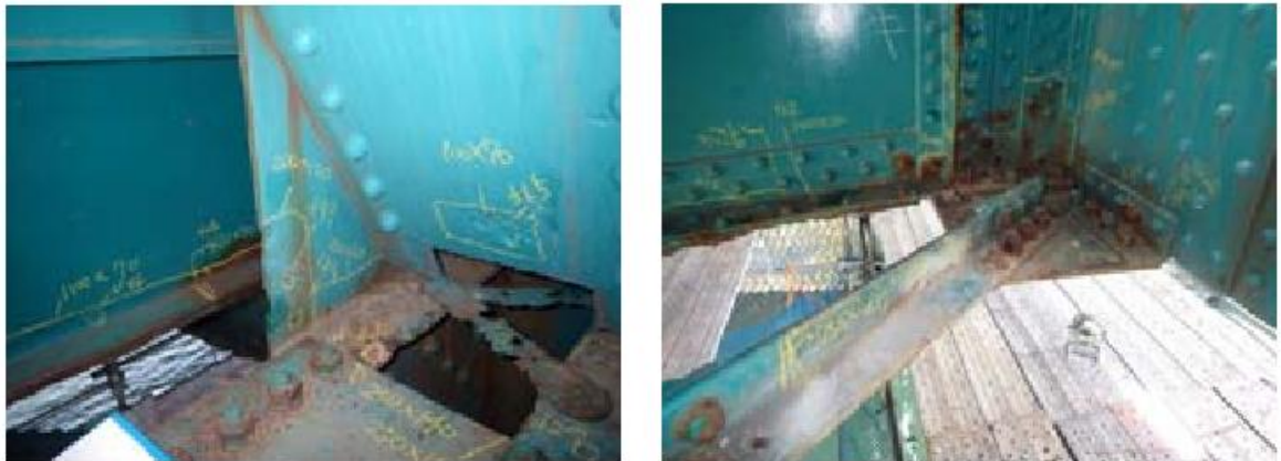
図-2-5-2-2 腐食損傷状況(左:トラス格点部、右:下横支材)
