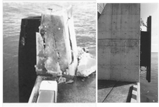
写真-6.1 フェリー用防舷材の一例
