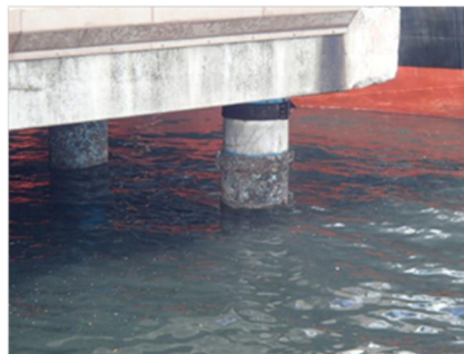
写真-5.3 栈橋の事例（鋼管杭の損傷）
