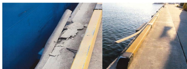
写真-5.11 コーナー材損傷の事例
