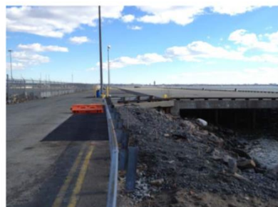
写真-A.2.15 被災状況写真 12) (護岸の被災)
