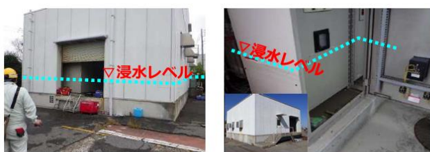
受電所の浸水(床上約30cm)
