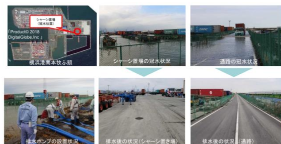
写真-A.2.8 被災状況写真 7) (横浜港南本牧シャーン置場)
