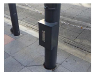
写真-3 照明柱に設置されたコンセントボックス
