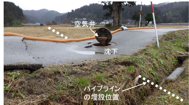
写真－10.12 道路横断部の道路地盤の沈下
