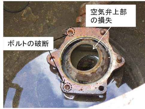
写真－10.10 空気弁上部の破損（図－10.9 の拡大）
