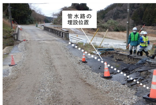
写真-10.2 管路の埋設部の沈下状況
