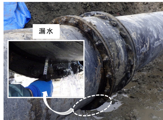
写真-10.6 継輪部からの漏水状況
