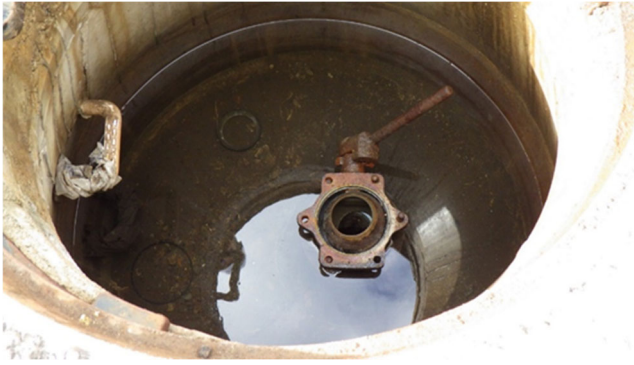
写真－10.9 空気弁上部の破損状況
