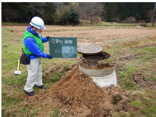
写真-10.1 マンホールが隆起した状況
