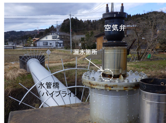
写真-10.8 腐食箇所における破損
