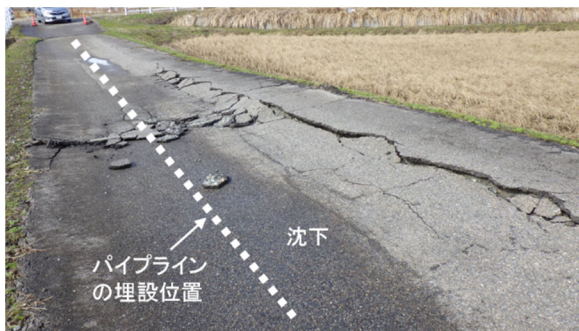
写真－10.11 パイプライン直上の道路地盤の沈下
