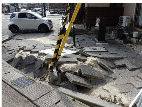
写真-9.5.7 舗装が破損した無電柱化路線（液状化の痕跡を確認） 能登町宇出津新 県道35号
