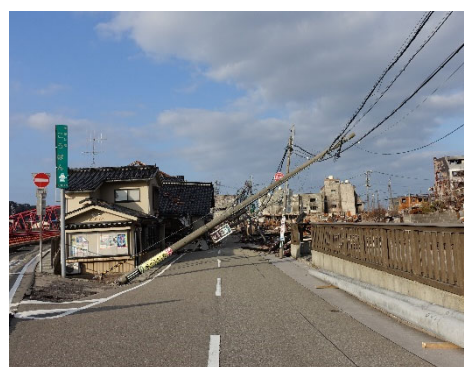
写真-9.5.4 電柱の倒壊状況 輪島市河井町
