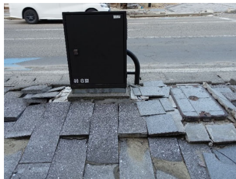
写真-9.5.2 路面の不等沈下状況 （地上機器周辺） 輪島市河井町 県道1号
