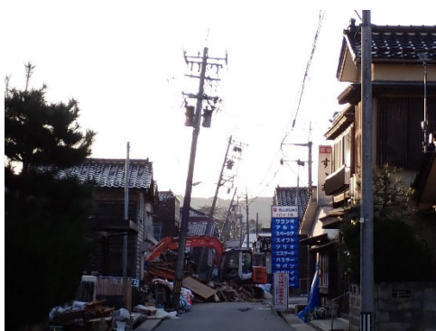
写真-9.5.3 連鎖した電柱の傾斜状況 輪島市河井町
