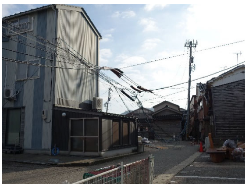
写真-9.5.5 電線の垂れ下がり状況 輪島市河井町
