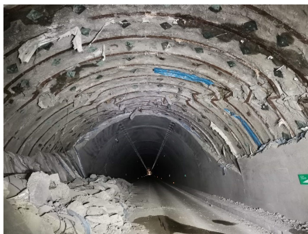
(b) 支保工の変状
