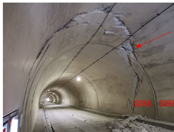
写真-9.4.14 S085～S086 付近の変状の状況
