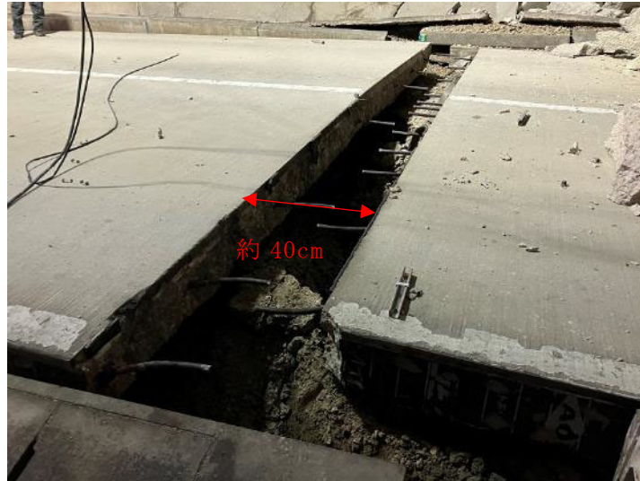
写真-9.4.2 舗装目地の開口
