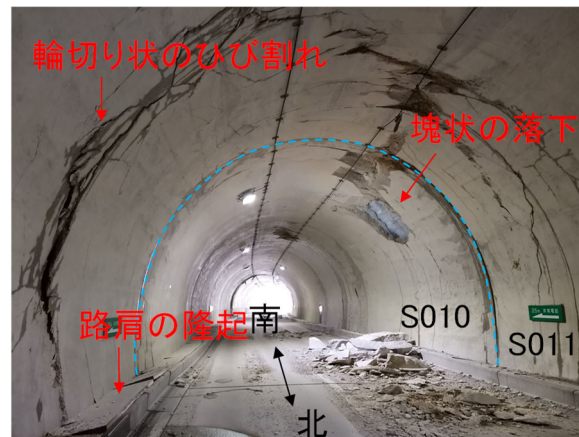
写真-9.4.13 S010 付近の変状の状況
