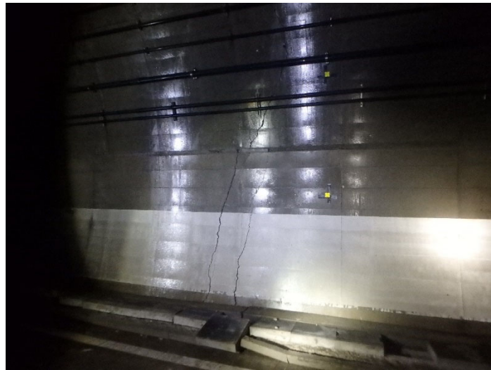
(b) 縁石の変形
