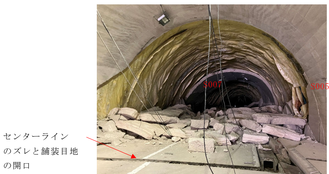
写真-9.4.1 覆工の崩落状況
