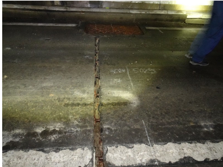
(a) 舗装目地の開口
