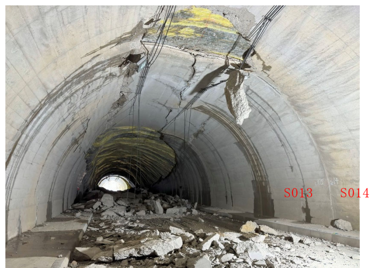
写真-9.4.4 覆工の塊状の落下状況
