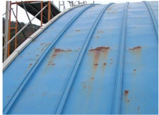
(b) 部分的な発錆
