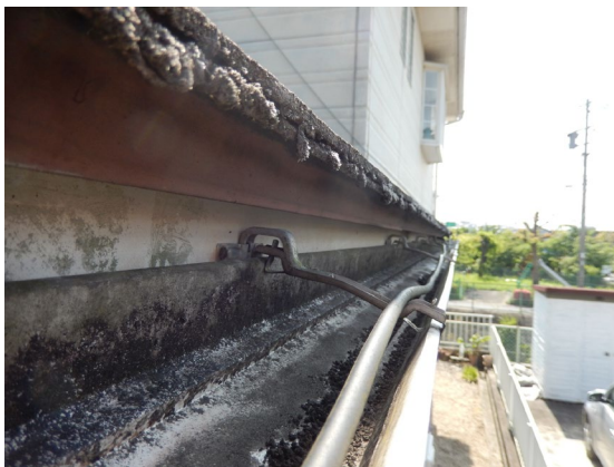
(a) 底に塵埃等が溜まった状況
