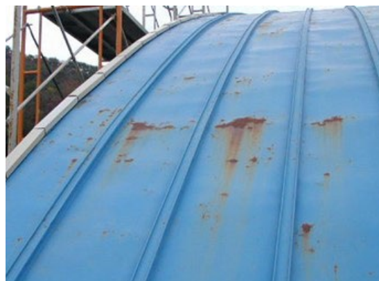
(b) 部分的な発錆
