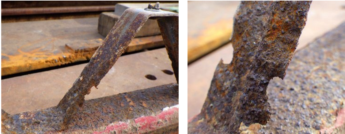
解図 3.2.4 タイトフレームの断面欠損の状況の例 (画像提供 (一社) 日本金属屋根協会)
