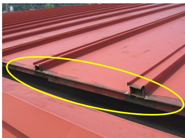
(c) 瓦棒ぶきの軒先と唐草の一部の劣化状況
