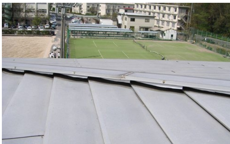
解図 3.2.3 ドリルねじの緩みや外れによって下り棟部材が浮いた状況の例 (画像提供 (一社) 日本金属屋根協会)
