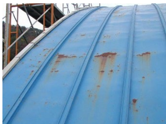
(b) 部分的な発錆
