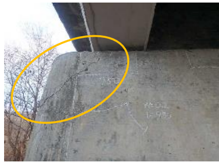
斜めひびわれ
