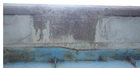
剥離・鉄筋露出
