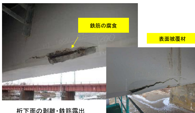
桁下面の剥離・鉄筋露出
