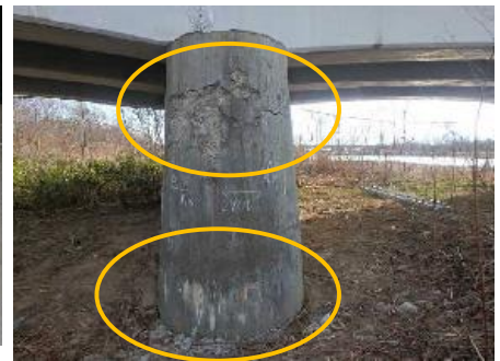
ひびわれ・剥離、遊離石灰
