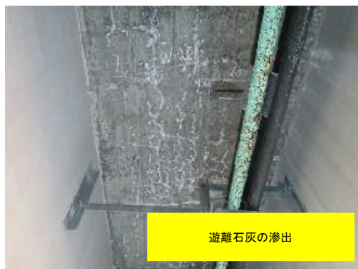
床版下面のひびわれ
