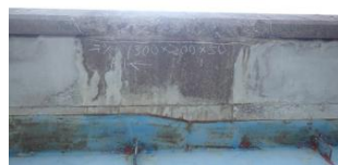
剥離・鉄筋露出
