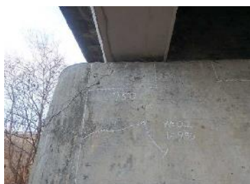
斜めひびわれ
