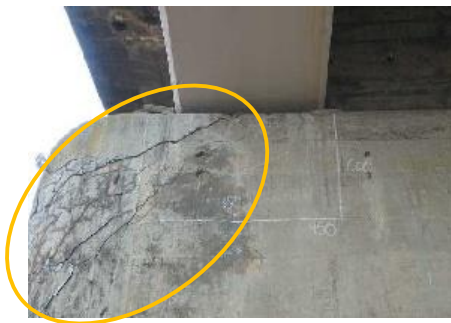
斜めひびわれ
