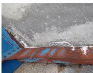
漏水・遊離石灰、うき
