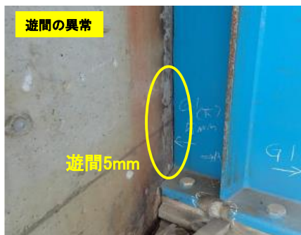
桁遊間の異常
