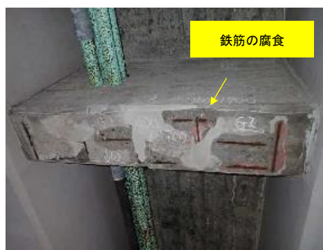
横桁下面の剥離・鉄筋露出
