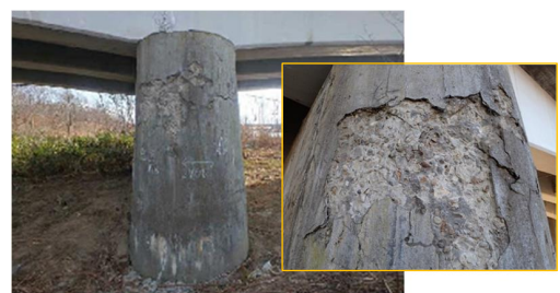
ひびわれ・剥離、遊離石灰
