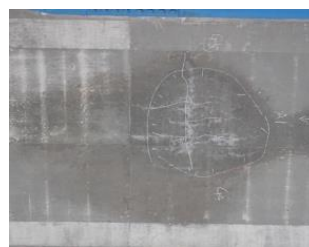
床版ひびわれ、 漏水・遊離石灰
