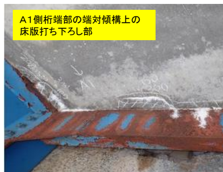
漏水・遊離石灰、うき
