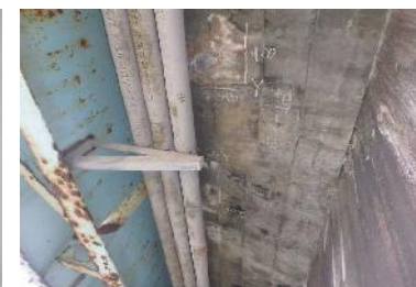
遊離石灰・漏水
