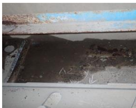
漏水・滞水(A2橋台橋座部)
