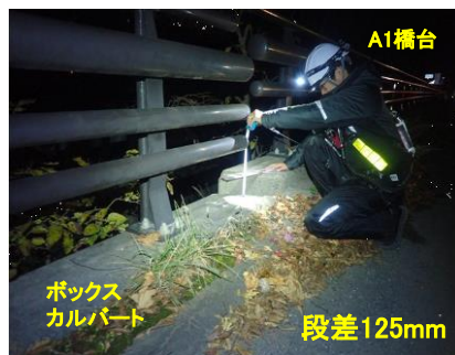
A1橋台ウイングと背面のボックスカルバートとの段差
