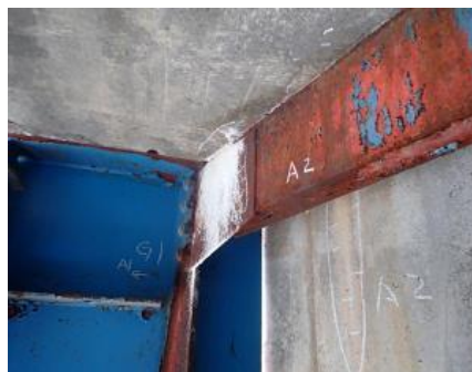
端対傾構の腐食
