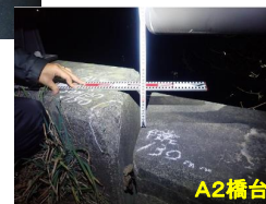
橋台ウイングと橋台背面ボックスカルバートとの段差
