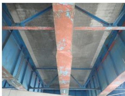
主桁の防食機能の劣化
