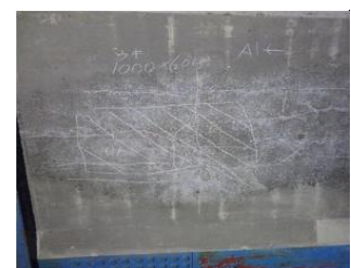
床版ひびわれ、 漏水・遊離石灰
