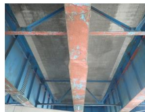
防食機能の劣化
