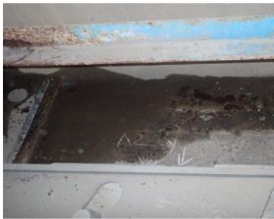
漏水・耐水 (橋座部)
