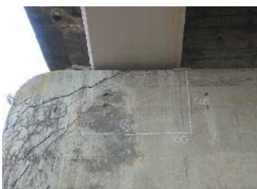
斜めひびわれ
