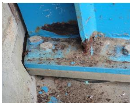
主桁支点部の腐食
