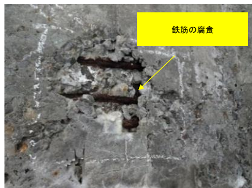
床版下面の コンクリート脱落
