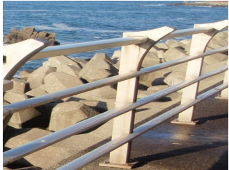
歩行者用転落防止柵(谷側)
