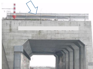
頂版端部の雪庇防止板
