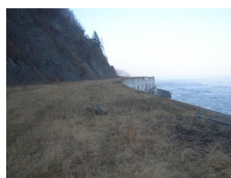
ロックシェッドの頂版上の状況
