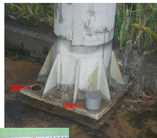
標識柱アンカーボルトの破断
