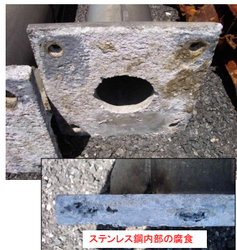
SUS製照明柱基部の塩害の腐食
