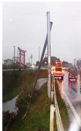
亀裂進行に伴う破断の例
