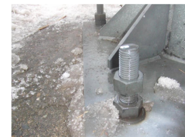
ボルトの緩み (施工不良)
