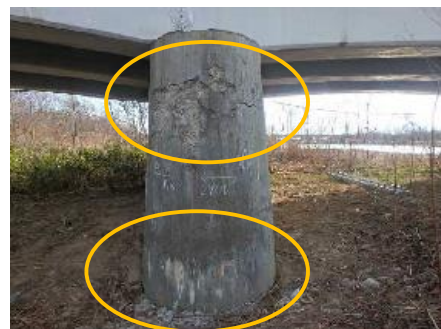
ひびわれ・剥離、遊離石灰
