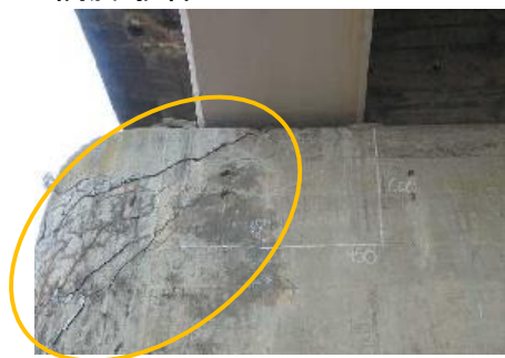
斜めひびわれ
