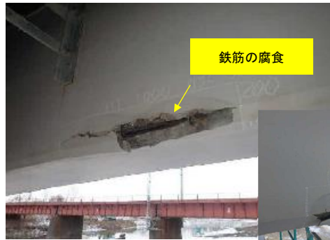
桁下面の剥離・鉄筋露出
