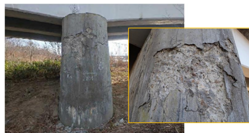
ひびわれ・剥離、遊離石灰
