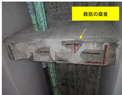
横桁下面の剥離・鉄筋露出
