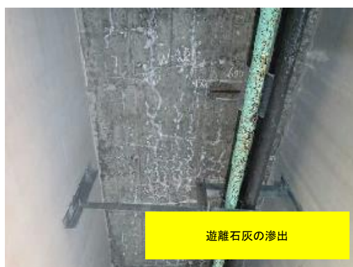
床版下面のひびわれ
