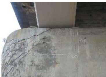
斜めひびわれ
