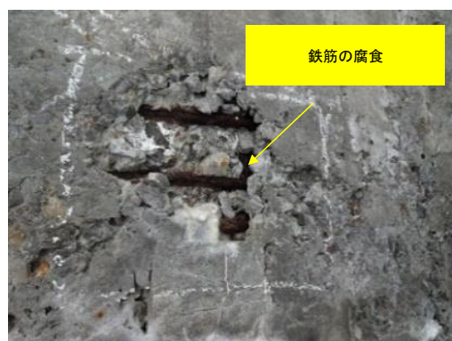
床版下面の コンクリート脱落
