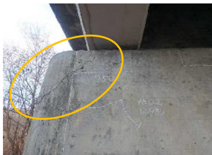
斜めひびわれ
