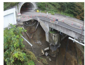
深礎基礎の周辺地盤が喪失し、鉛直・水平外力に対して基礎が不安定化することが懸念される
