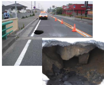
護岸又は基礎洗掘部から橋台背面土が吸い出されると、橋台アプローチ部の踏み抜き、橋台の沈下、傾斜が懸念される
