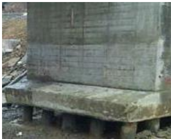
基礎周辺地盤が洗掘されると、基礎の鉛直・水平支持力が低下する
