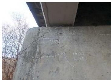
斜めひびわれ
