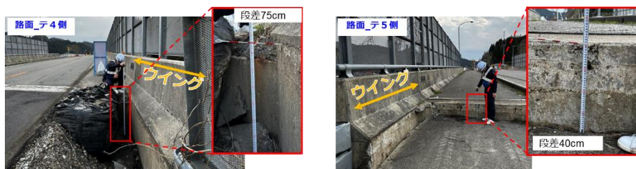
図- 2.3.1.9 事例：テ4、テ5 の段差発生状況
