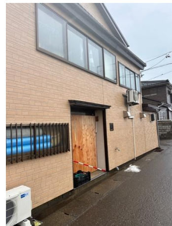
写真 5.7-3 浸水したと見られる住宅
