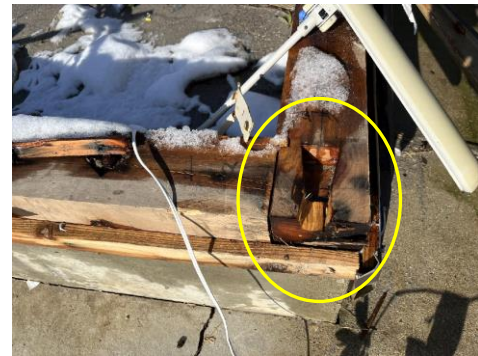
写真 5.7-29 流失した住宅の土台の状況
