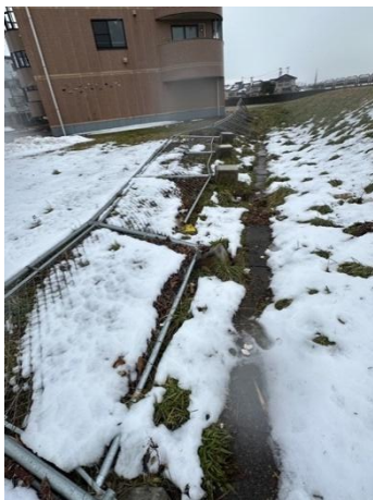
写真 5.7-1 フェンスの倒壊
