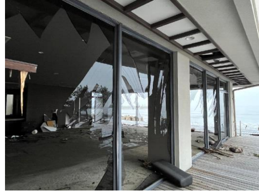
写真 5.7-9 1階の窓ガラスの損傷(2)
