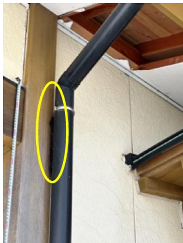
写真 5.7-15 津波の痕跡高さ
