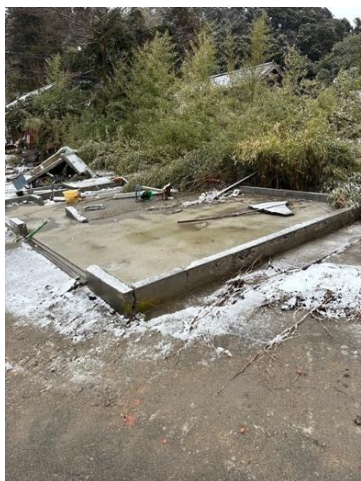
写真 5.7-22 上部構造の流失
