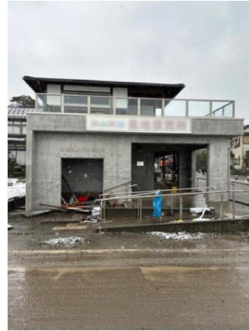
写真 5.7-25 RC 造建築物の被害状況
