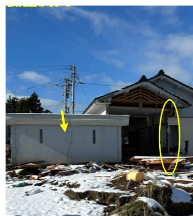
写真 5.7-27 外壁の損傷と隅柱の流失
