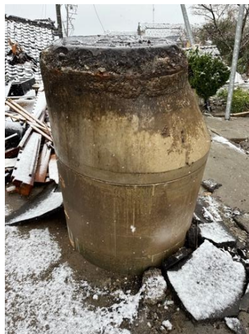
写真 5.7-19 突出したマンホール
