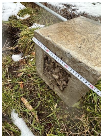
写真 5.7-2 フェンスの引き抜けた基礎
