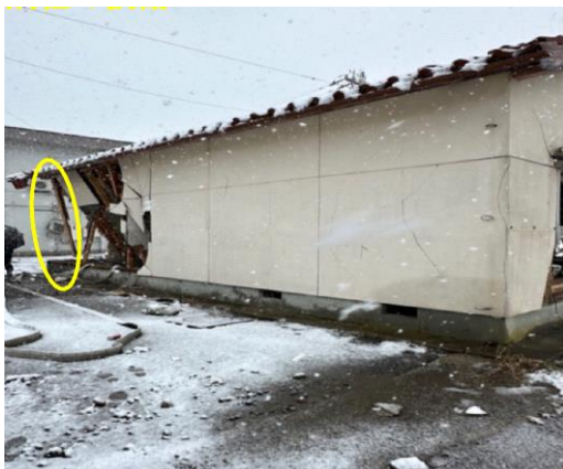
写真 5.7-20 津波の波圧による損傷
