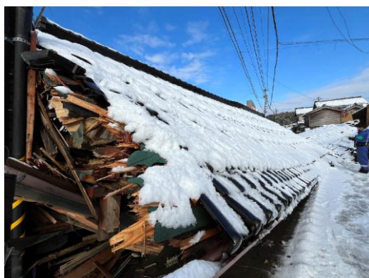
写真 5.7-40 倒壊した建築物の瓦屋根
