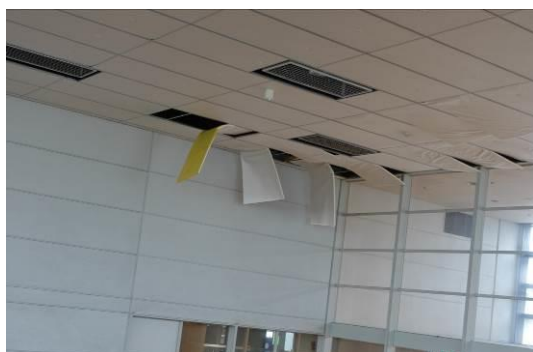
写真 5.6.2. (1)-1 屋内運動場のグラスウール板の垂れ下がり (建築物 C：金沢市、運動施設)
