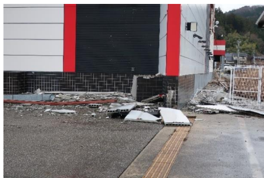
写真 5.6.2.(3)-14 脱落した ECP (WA-15：輪島市、遊技施設)
