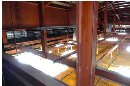
写真 5.6.2. (1)-2 屋内運動場の天井材垂れ下がり部分の支持状況 (建築物 C：金沢市、運動施設)
