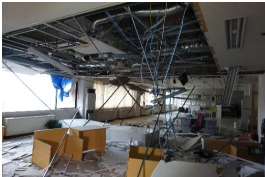
写真 5.6.2.(1)-23 事務所部分 4 階天井の被害（WA-104：輪島市、音楽等 用ホールを有する施設）
