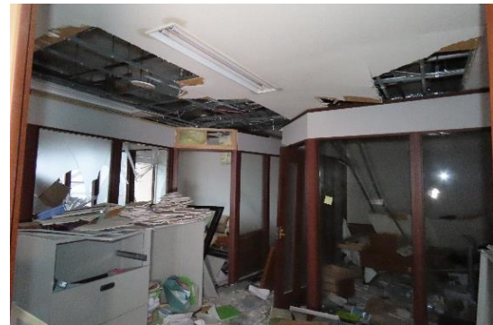
写真 5.6.2.(1)-24 事務所部分 5 階執務室天井・間仕切壁の被害（WA-104：輪島市、 音楽等用ホールを有する施設）
