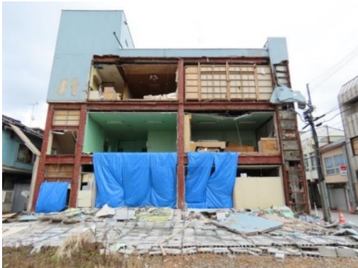
写真 5.6.2. (3)-17 ALC パネル、コンクリートブロック壁の脱落・転倒 (NA-04: 七尾市、事務所)
