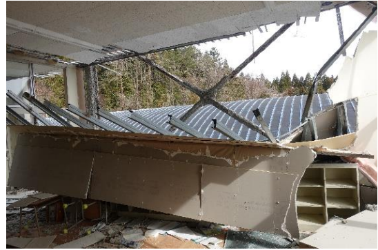
写真 5.6.2. (2)-15 3 階内壁の転倒被害 (一部上ランナは天井下地材に残っている) (WA-111：輪島市、教育施設)
