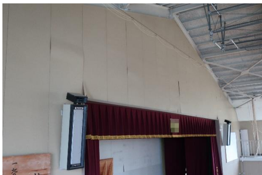
写真 5.6.2. (2)-5 屋内運動場 1 プロセニアムアーチの内装仕上材の損傷 (NA-106 : 七尾市、教育施設)
