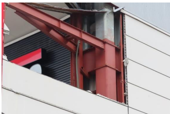
写真 5.6.2.(3)-13 ECP による外壁の被害 (WA-15：輪島市、遊技施設)
