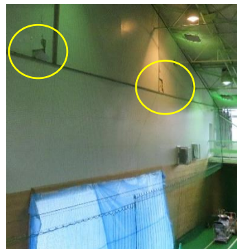
写真 5.6.2. (2)-4 全天候型広場 内壁の被害（WA-102：輪島市、教育施設）
