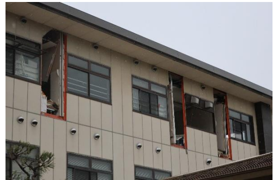
写真 5.6.2. (2)-19 校舎張間方向の外壁の脱落 (AN-101：穴水町、教育施設)
