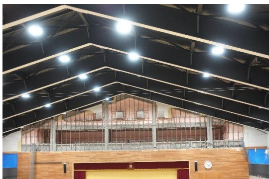
写真 5.6.2. (2)-1 屋内運動場 妻面（プロセニウムアーチ上部）の内壁の広範囲な脱落（WA-102：輪島市、教育施設）
