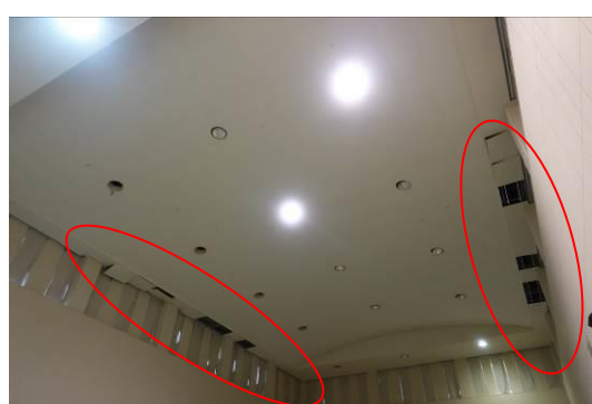
写真 5.6.2. (1)-4 屋内運動場のグラスウール板数枚の落下 (建築物 O：富山市、運動施設)
