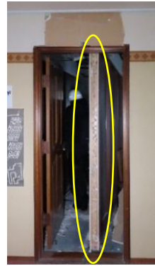
写真 5.6.2. (2)-17 事務所 5 階 間仕切壁の被害 (壁が床の上を移動) (WA-104：輪島市、音楽等用ホールを有する施設)
