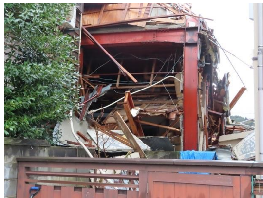
写真 5.5-4 1 階は倒壊していない
