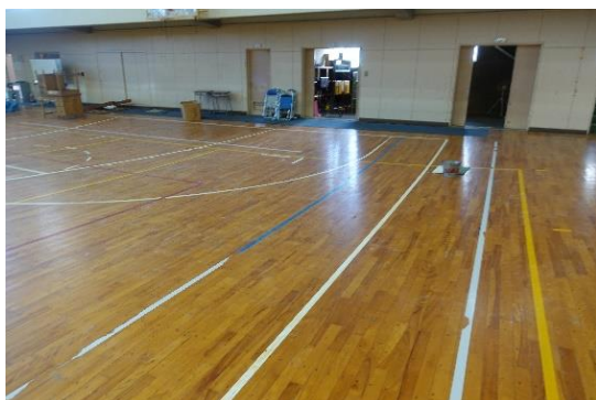
写真 5. 5-145 第二体育館 床の沈下
