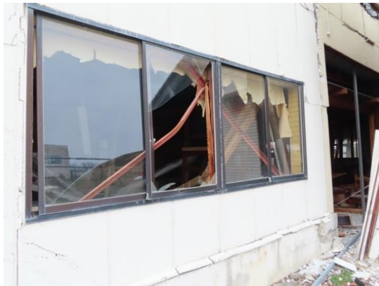
写真 5.5-70 山形鋼ブレースの座屈
