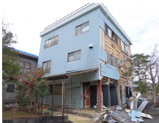
写真 5.5-79 外壁の脱落（裏側）
