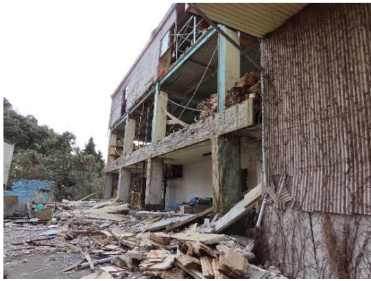
写真 5.5-63 建築物前面の外壁の脱落
