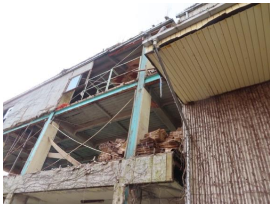
写真 5.5-68 ターンバックルブレースのたわみ
