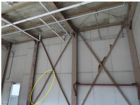
写真 5.5-61 山形鋼ブレースの変形
