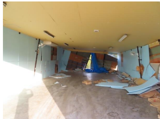
写真 5.5-37 床の沈下、傾斜
