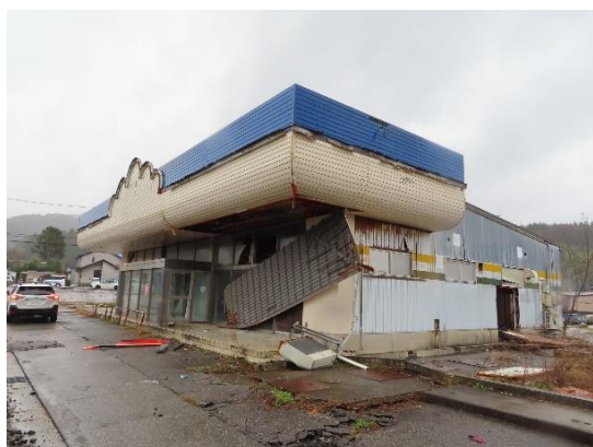
写真 5.5-96 外観（軒天井の脱落）
