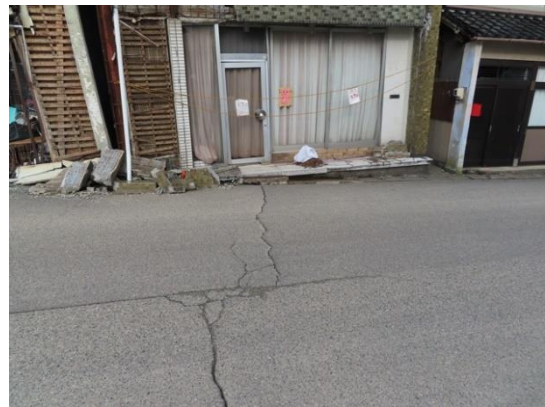
写真 5.5-28 付近の地面の様子
