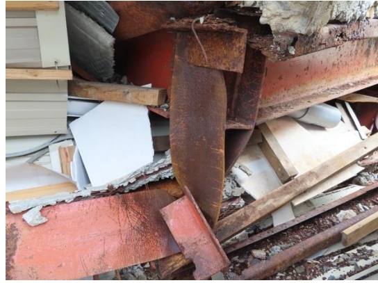
写真 5.5-12 1階 H 形鋼柱の柱頭部の座屈
