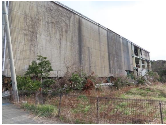
写真 5.5-64 建築物背面の外壁の脱落
