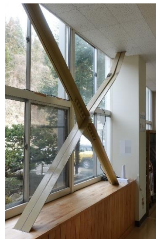
写真 5.5-162 1階ブレースの座屈の被害
