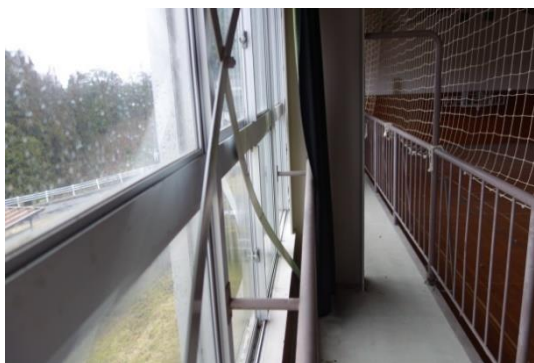
写真 5.5-152 ブレースのたわみ
