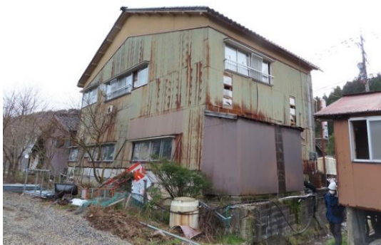
写真 5.5-25 建築物の裏側からは大きな残留変形 (たわみ) が見られた
