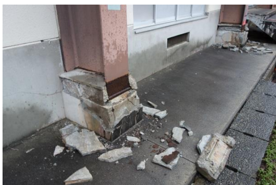
写真 5.5-153 柱脚部のコンクリートの破壊
