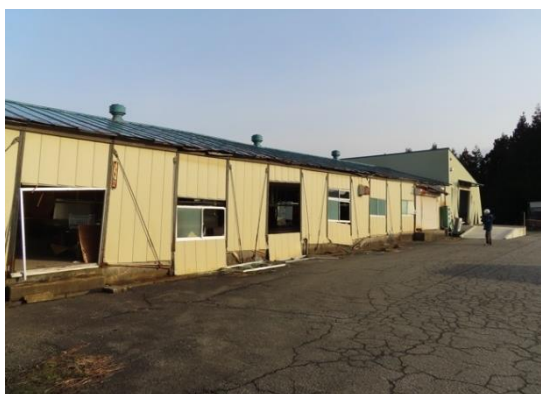
写真 5. 5-82 外観及び外壁・サッシの脱落状況
