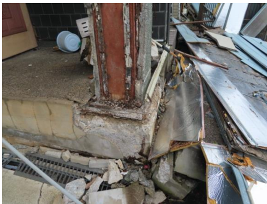
写真 5. 5-81 露出柱脚のコンクリートの破壊
