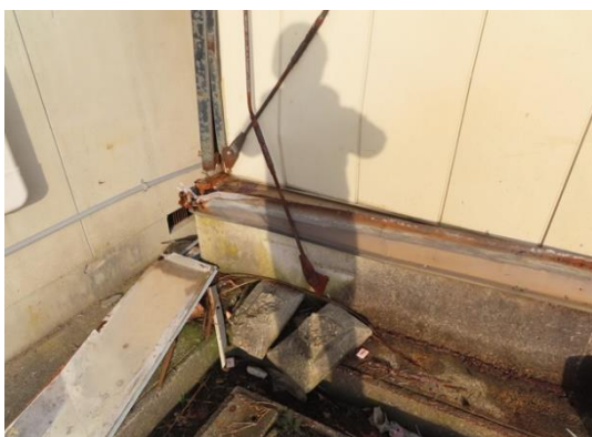
写真 5. 5-83 ターンバックルブレースの座屈及び溶接接合部の破断
