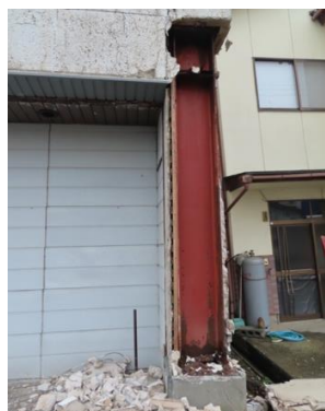
写真 5.5-75 柱脚の錆と腐食
