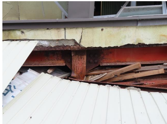
写真 5.5-14 倒壊した 1 階の柱頭部の梁端部接合部及び柱の座屈状況
