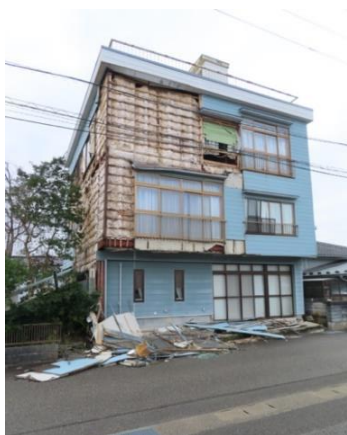
写真 5.5-78 外壁の脱落（表側）
