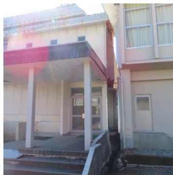
写真 5. 5-142 第一体育館と第二体育館の隙 間
