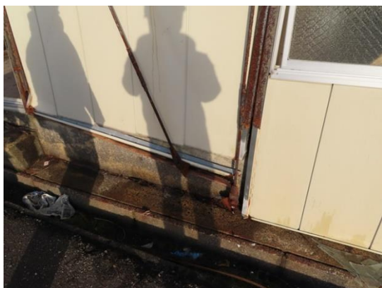
写真 5. 5-84 溝形鋼組立て材柱の錆と破断
