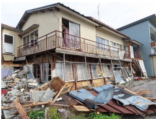
写真 5.5-30 1階の大きな傾き
