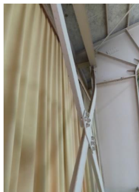
写真 5.5-139 第一体育館 山形鋼ブレース （1 丁）の面外たわみ
