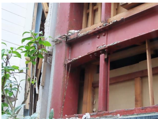
写真 5. 5-91 日の字断面柱の柱梁接合部の柱溶接部の亀裂
