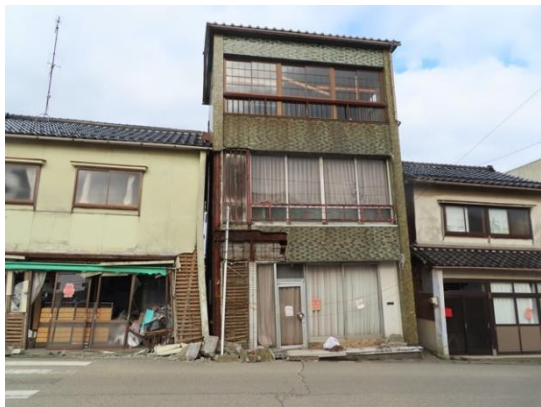
写真 5.5-27 外観（建築物全体の傾斜）
