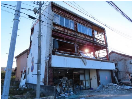
写真 5.5-53 建築物前面の外壁、窓ガラスの脱落
