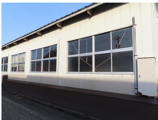
写真 5.5-88 ブレースの座屈
