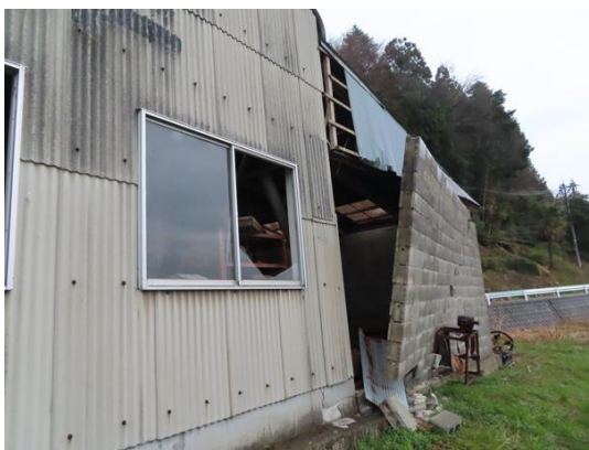
写真 5. 5-93 下屋のコンクリートブロック外壁が一部倒れかかっている
