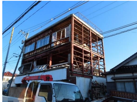
写真 5.5-54 建築物側面の広範囲で外壁脱落
