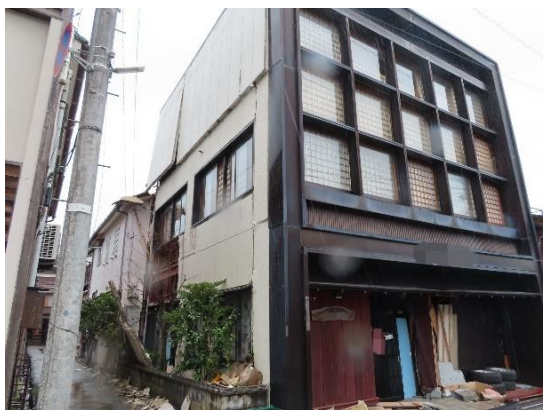
写真 5. 5-89 外観（側面の外壁の脱落）
