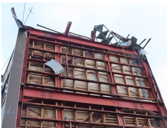
写真 5.5-109 側面の外壁の広範囲での脱落
