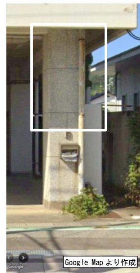
d) 地震前（2023 年 10 月）5.4-6)より作成の状況 （□部が写真 c で沈下後に露出した部分）
