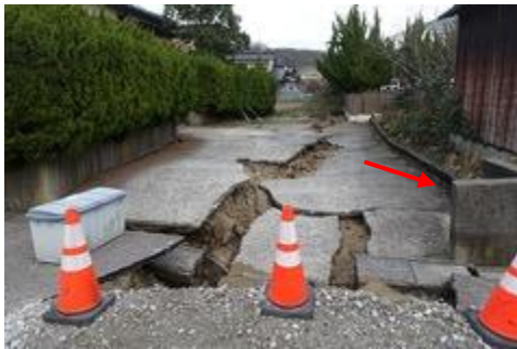
o) 側方流動した地盤と地割れ
