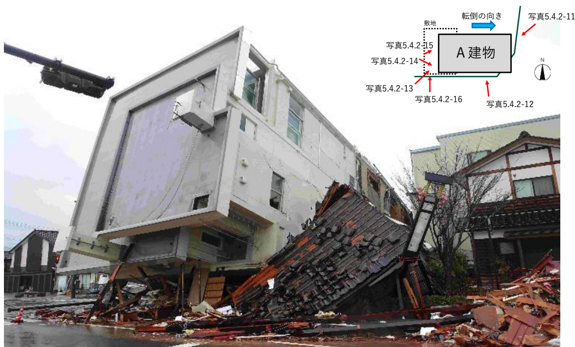
写真 5. 4. 2-11 転倒したA建物（東側から撮影）
