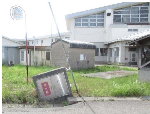
写真 5.4.2-49 敷地地盤の変状 (右奥がS棟)
