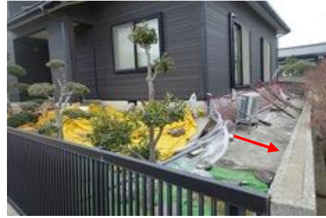
n) 住宅周辺の地盤変状
