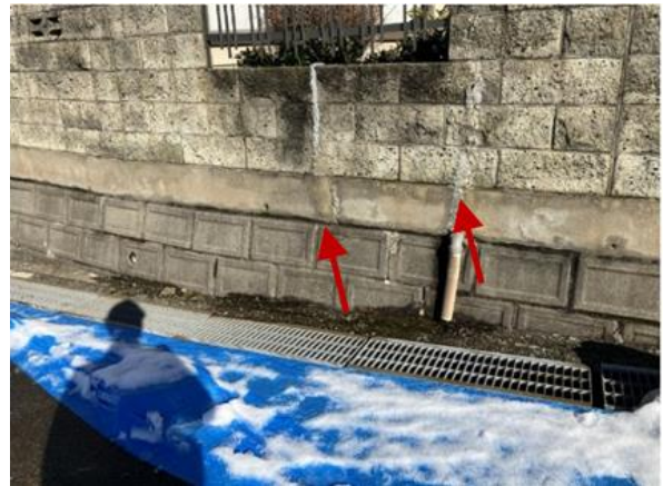
写真 5.4.2-4 ブロック塀のひび割れと補修痕
