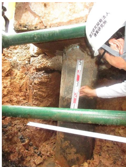
写真 5. 4. 2-53 杭④の被害状況
