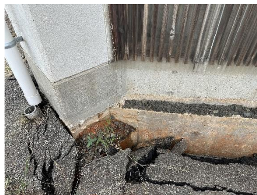
写真 5.4.2-50 基礎ばり周囲の沈下 (X4-Y15 位置)
