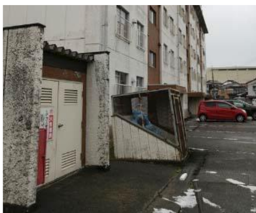
写真 5. 4. 2-41 ごみ集積場の被害（傾斜）
