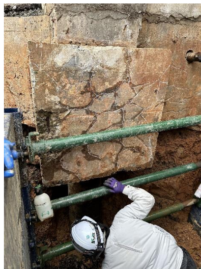
写真 5. 4. 2-54 杭④パイルキャップの被害状況
