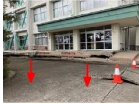
f) 周辺地盤が沈下した建物
