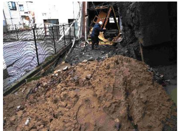
写真 5.4.2-16 地表面の変状（敷地の南側）
