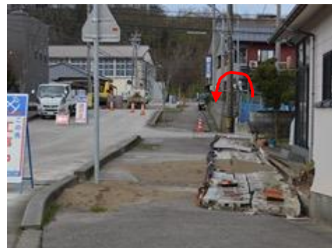
j) 擁壁の転倒
