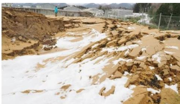
写真 5. 4. 2-43 校庭の地割れ
