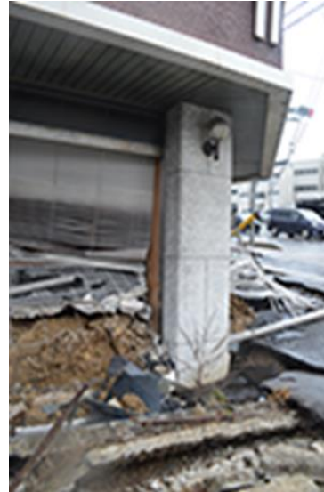
b) 南東隅柱
