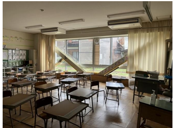
写真 5. 4. 2-36 1 階での床面の盛上り（教室棟）
