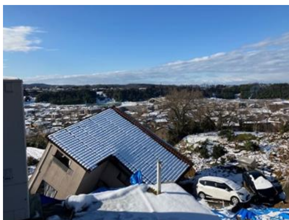
写真 5.4.2-1 崩壊した斜面の状況①
