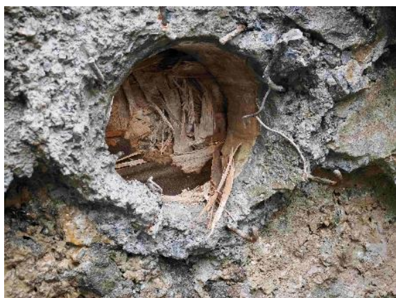
a) パイルキャップの木片
