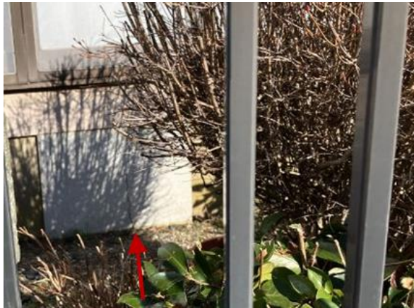
写真 5.4.2-3 住宅の基礎立上り部のひび割れ
