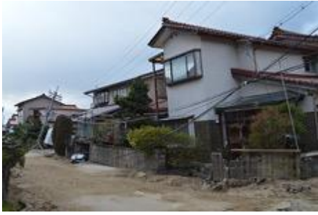
m) 住宅の沈下
