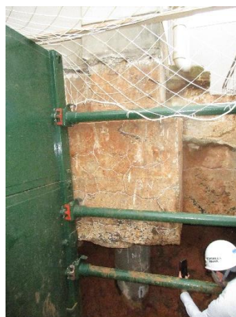
写真 5.4.2-52 杭③パイルキャップの被害状況
