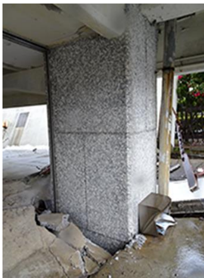
c) 北東隅柱の沈下状況
