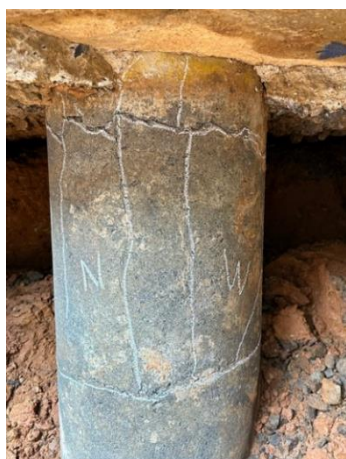
写真 5.4.2-51 杭③の被害状況
