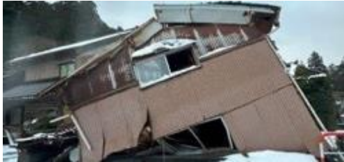
写真 5.2.2-66 倒壊した納屋
