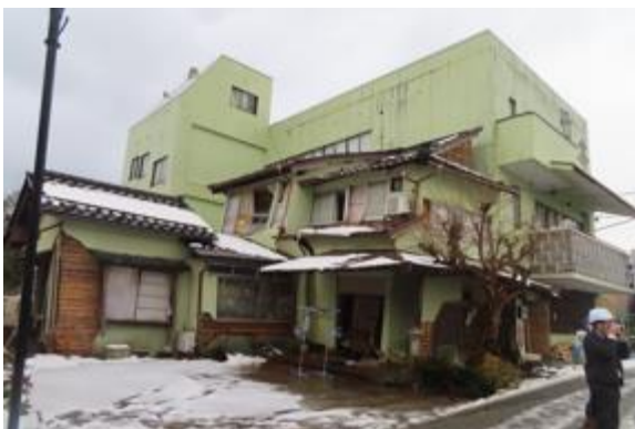
写真5. 2. 2-62 2階が損傷した木造住宅
