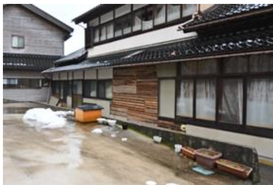
写真5.2.2-75 外壁の剥落した木造住宅
