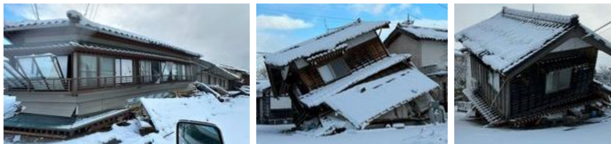
写真5. 2. 2-13 門前町門前・走出の倒壊家屋群
