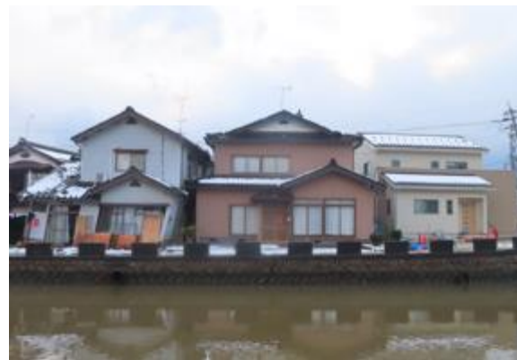
写真5. 2. 2-63 大きく傾斜した木造住宅 (左)
