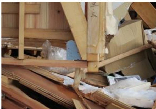
写真5.2.2-45 写真5.2.2-44の筋かい端部の金物
