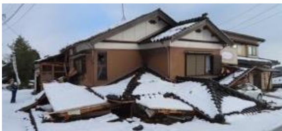
写真5.2.2-48 1層が崩壊した木造住宅
