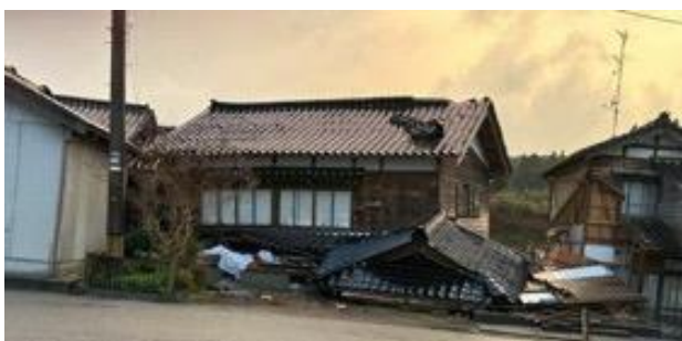
写真5. 2. 2-54 穴水町志ヶ浦の倒壊家屋
