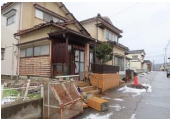
写真 5.2.2-68 外壁が剥落した木造住宅
