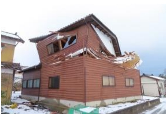
写真5.2.2-50 2層が崩壊した木造住宅
