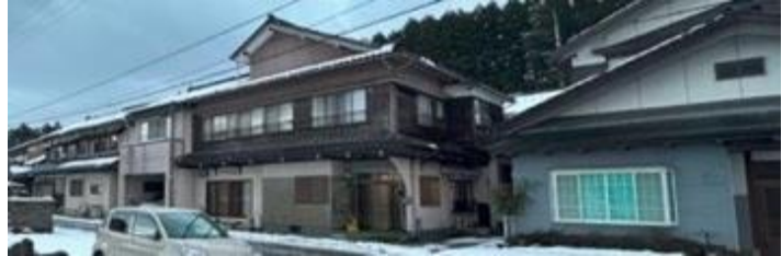
写真 5.2.2-67 外観上無被害に見える木造家屋
