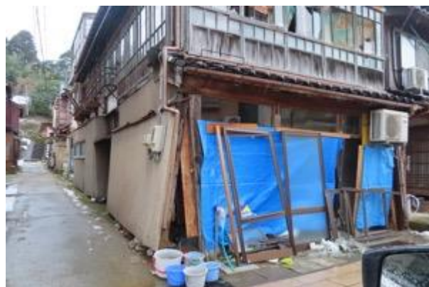
写真 5.2.2-69 大きく傾斜した木造店舗併用住宅
