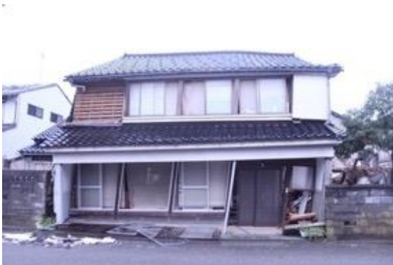
写真5. 2. 2-82 大きく傾斜した木造住宅
