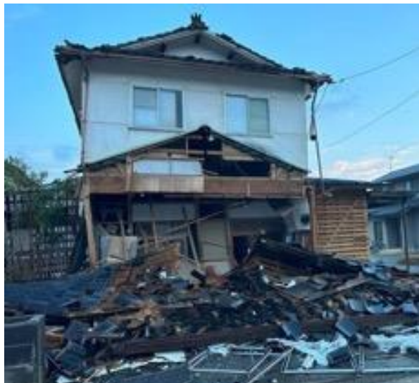
写真5. 2. 2-57 傾斜が残る住宅 (穴水町川島)
