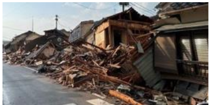
写真5. 2. 2-8 鳳至町の倒壊家屋群
