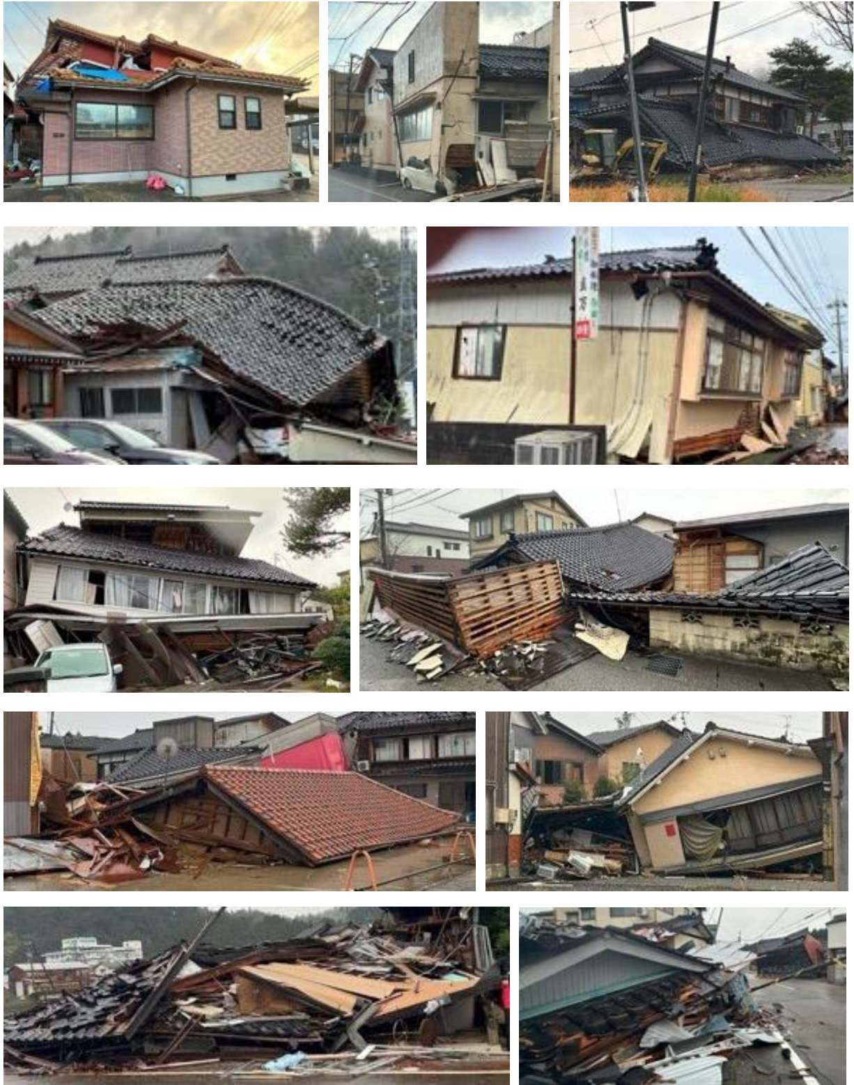
写真5. 2. 2-58 穴水町大町の倒壊家屋群
