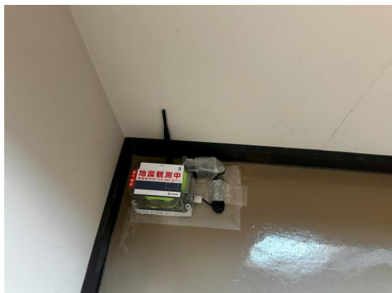
写真 4.4-7 強震計設置状況 (WJMC2 : 南東側 1 階、Sonas No.3)
