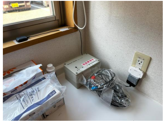
写真 4.4-13 強震計設置状況 (WJMF2 : 北側 1 階、CV374_146)
