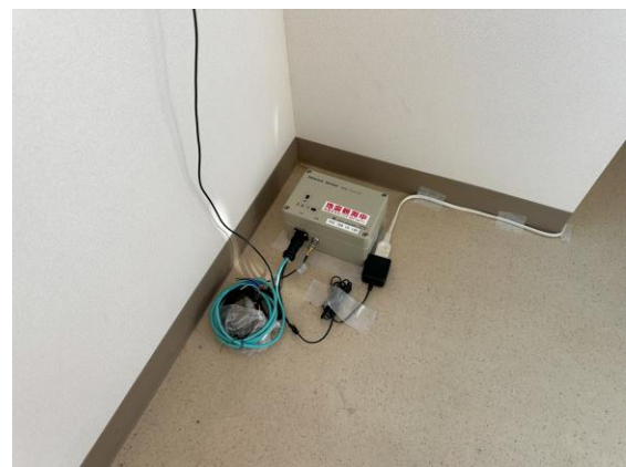
写真 4.4-15 強震計設置状況 (WJMF4 : 北側 3 階、CV374_148)
