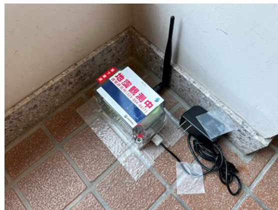
写真 4.4-8 強震計設置状況 (WJMC3 : 北西側 1 階、Sonas No.2)
