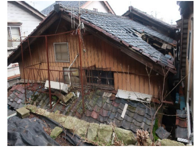
保安上危険な状態の空家の例
