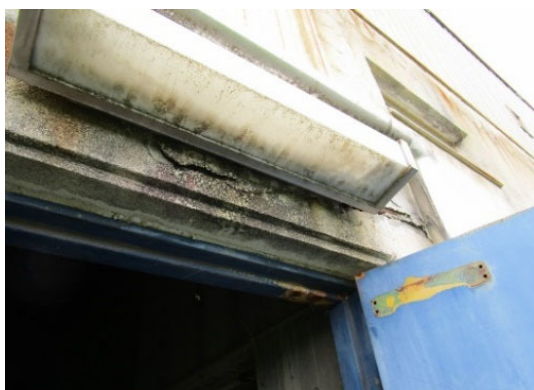
爆裂による鉄筋の露出 (波浪実験水路)
