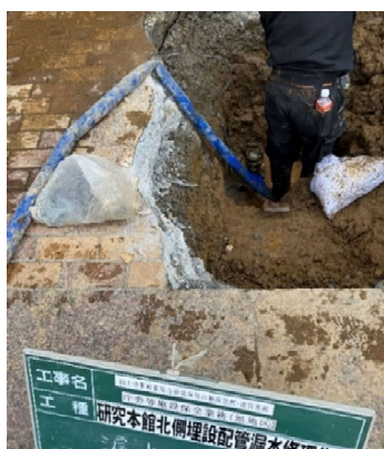
埋設配管からの漏水 (研究本館前庭)
