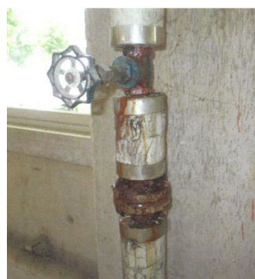
給水管の発錆・腐食 (河川水理実験施設)
