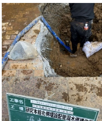
埋設配管からの漏水 (研究本館前庭)
