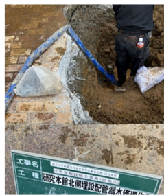
埋設配管からの漏水 [研究本館前庭]
