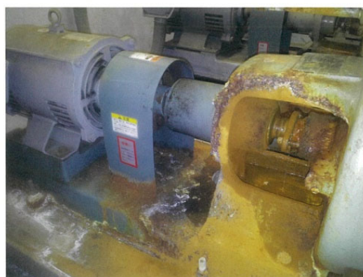
空調用冷温水ポンプの腐食 (水質水文共同実験棟)
