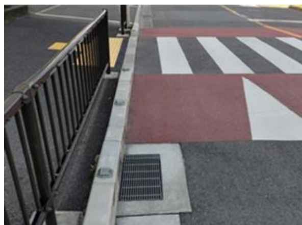
自発光鋲と集水枡(第1工区)
