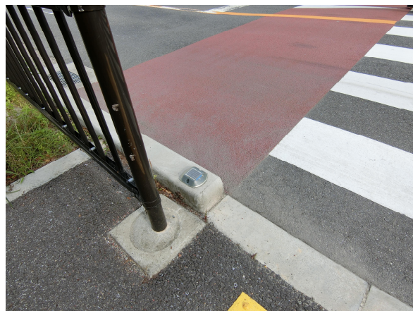
傾斜部の縁石と自発光鋲(第1工区)
