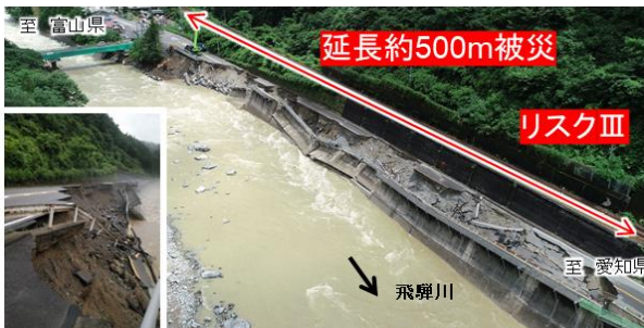
図-1 国道41号における洗掘被災の様子
