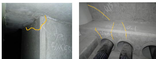
写真-1 隔壁の損傷事例
