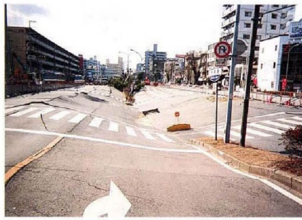
写真 3.1-2 国道28号線路面の陥没状況 (高速長田側を望む)
