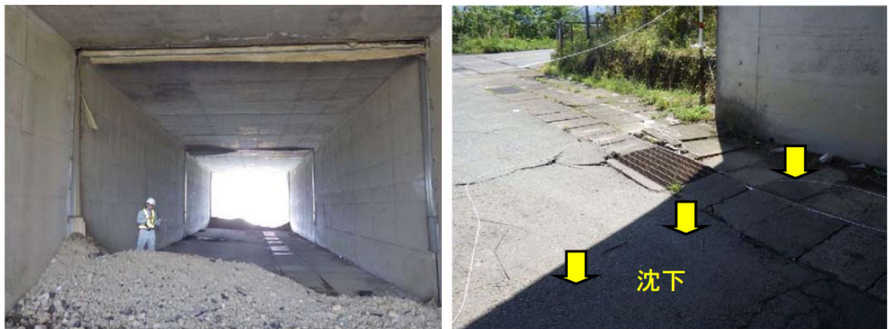
図 4.4 九州道ボックスの被害の状況（2/2） 28)
