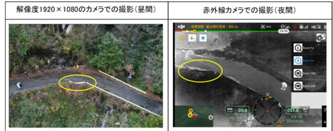
図-5 ガードレールの損傷（ホバリング撮影）
