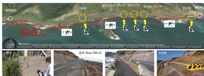
図-3 飛行ルートと被災事象及び被災箇所
