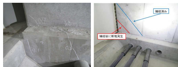
(c) 偏向部と壁の接合部の圧壊 (d) 下角部の補修後に新たにひび割れ
