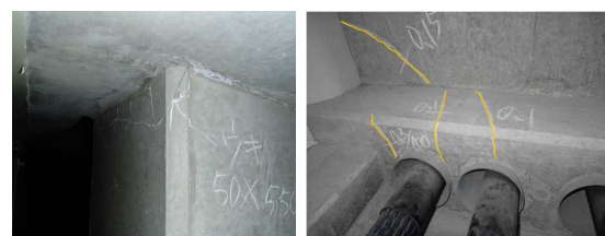
(a) 上角部の圧壊 (b) 外ケーブル偏向部からのひび割れ
