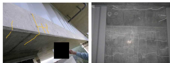
写真-2 鋼・コンクリート接合部、橋脚柱頭部のひび割れ事例
