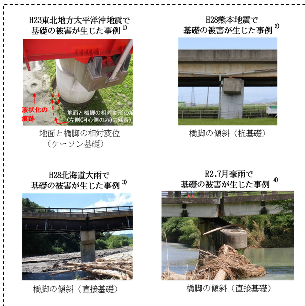
図 1-1 基礎の被害が生じた事例
