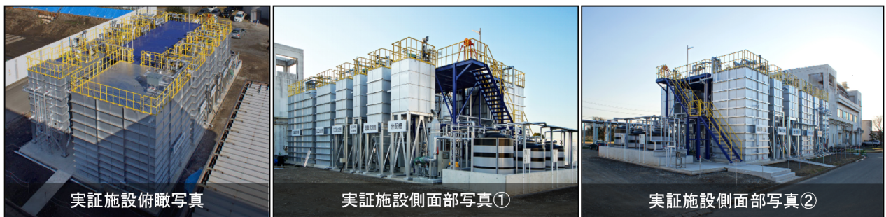
図資 1-3 実証施設写真
