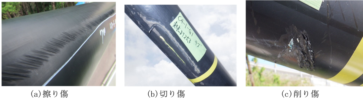
写真-4.2 外観調査で確認された桑鶴大橋のケーブルの被覆の傷の例
