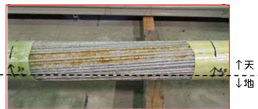
写真-4.3 被覆破損位置下方の素線の錆の状況
