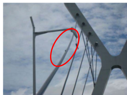
(c) 照明柱との緩衝による PE 被覆の損傷
