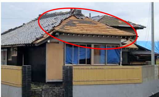
屋根瓦の脱落・飛散(令和元年房総半島台風)
