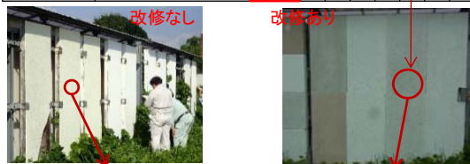
暴露20年目劣化調査 [複層塗材E]南面
