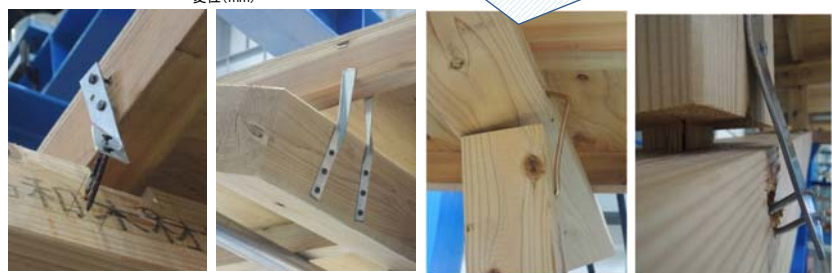
小屋組各部の損傷状況
