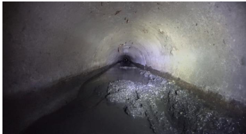
図 2-15 点検直視型カメラによる異常写真例（コンクリート管）
