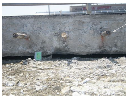
液状化した仙台空港のコンクリート舗装 (平面図の升目は7.5m×7.5mのコンクリート版)
