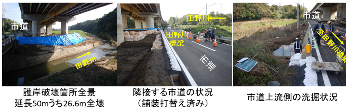
写真-5.2.14.3 ③田野川左岸被災状況
