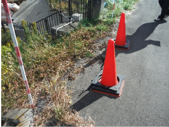
写真-5. 2. 17. 22 法肩の陥没
