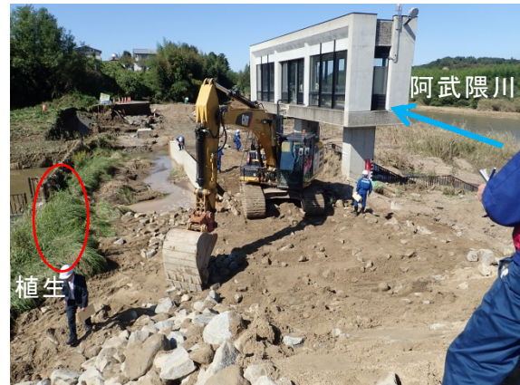
写真-5.2.2.4 川裏側の洗掘と周辺の植生
