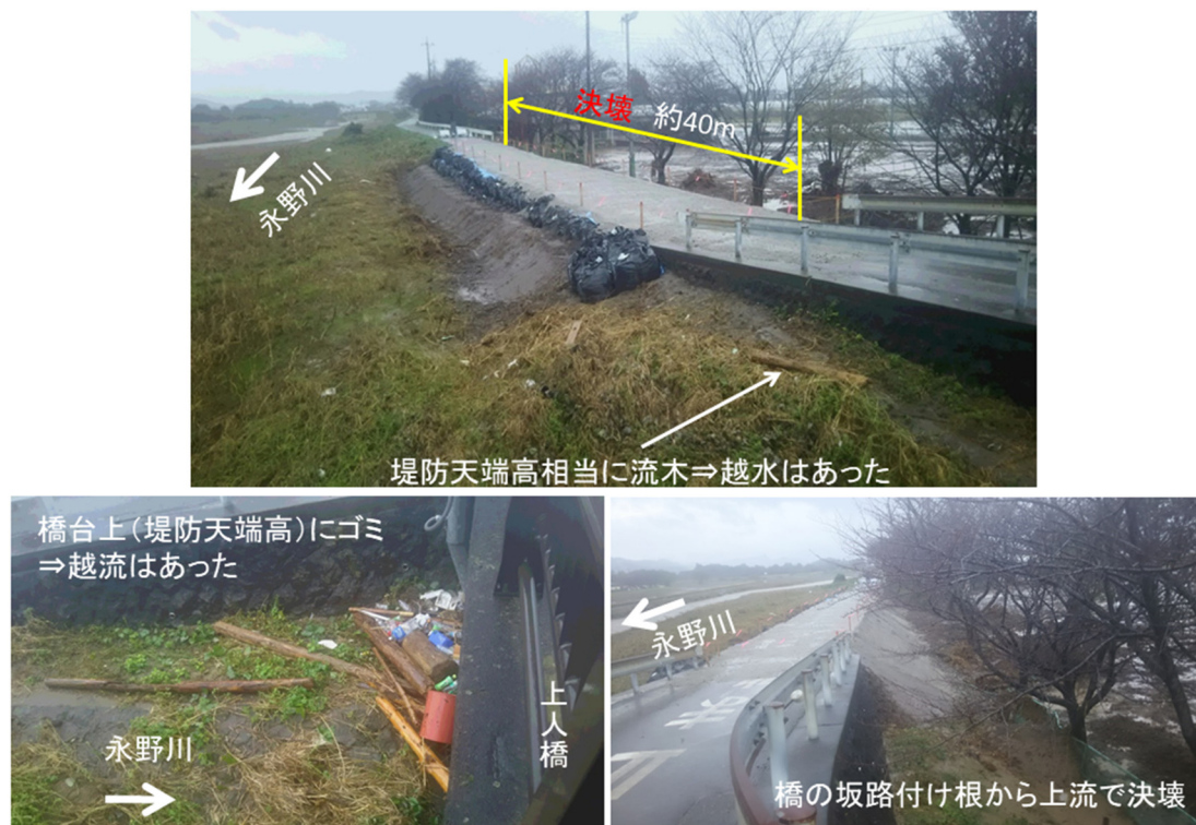
写真-5. 2. 8. 5 永野川左岸上人橋上流被災状況
