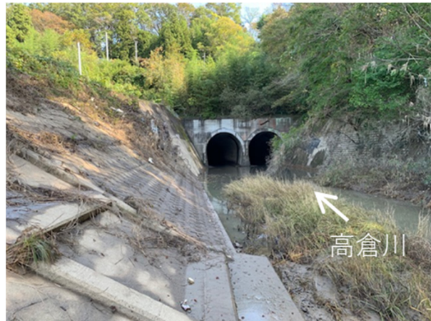
写真-5.2.12.20 決壊箇所下流のトンネル口
