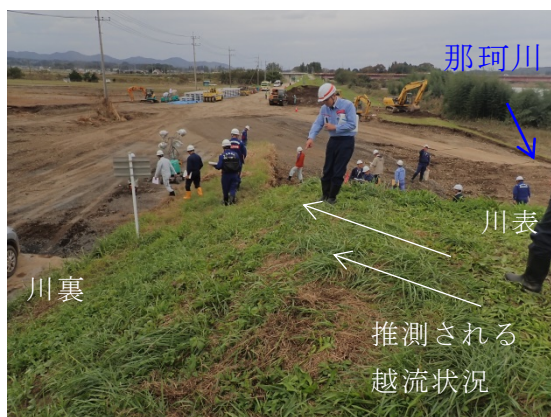
写真-5.2.4.3 決壊箇所下流部状況
