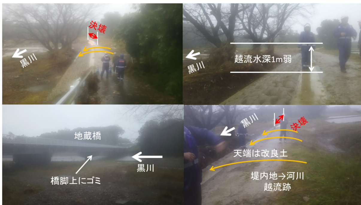
写真-5.2.8.8(1) 黒川左岸地藏橋上流被災状況
