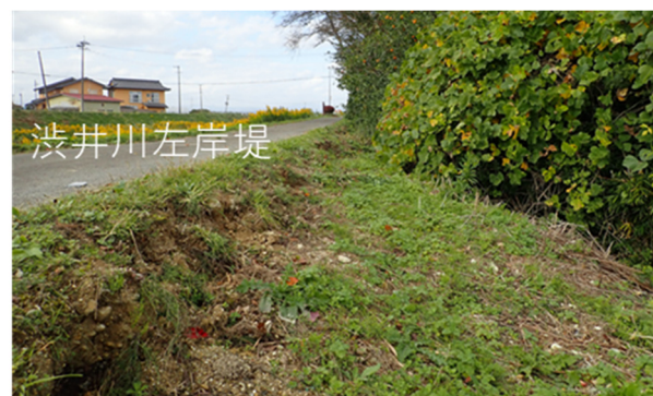
写真-5.2.12.8 渋井川 c 地点左岸堤裏法
