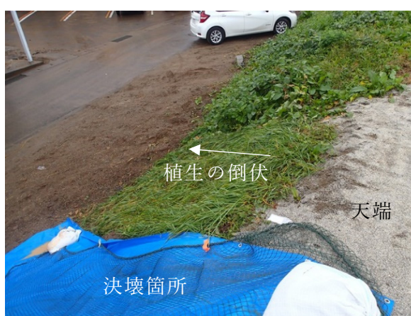
写真-5.2.5.32 濁川 越水痕
