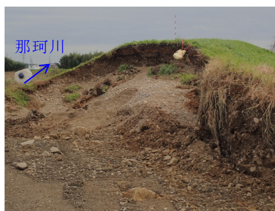
写真-5.2.4.6 決壊箇所の堤体断面（下流側）
