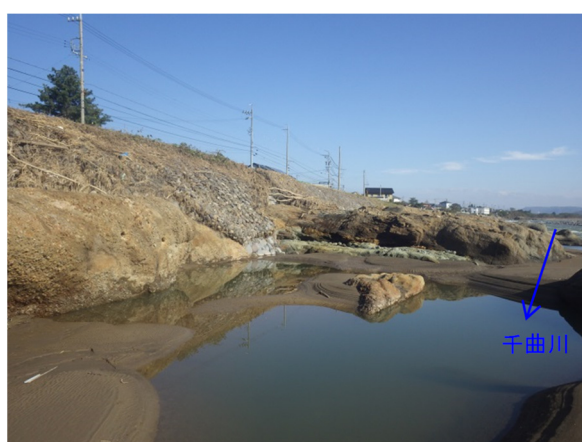
写真-5.2.13.18 千曲川右岸 107.0KP 川表侵食状況
