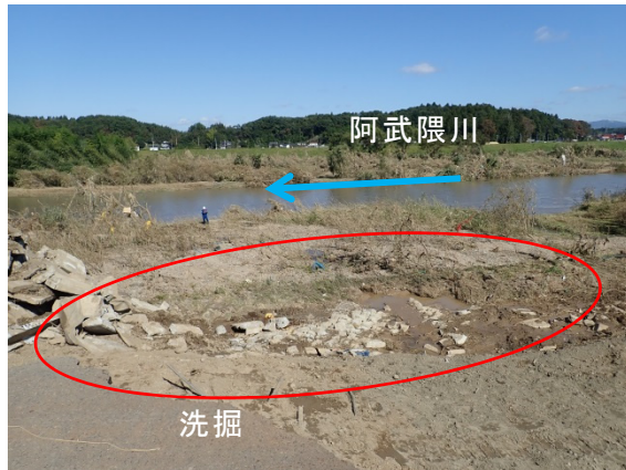
写真-5.2.2.3 川表側の洗掘状況
