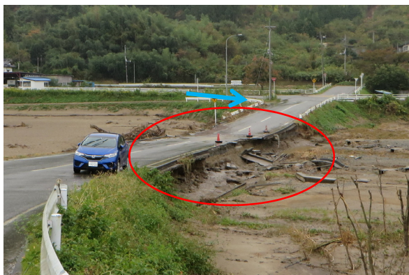
写真-5.2.10.11 道路の被災状況
