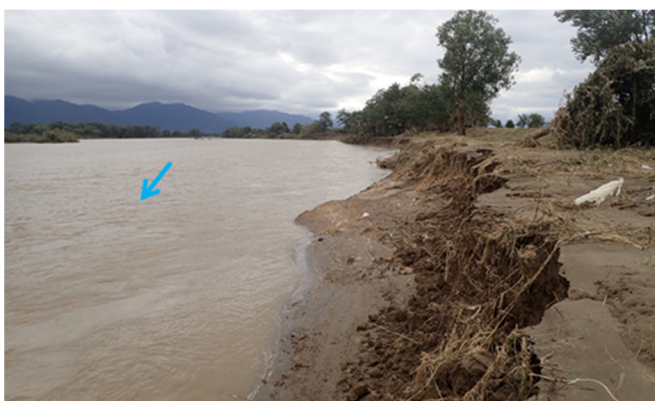
写真-5.2.1.8 低水路河岸（侵食状況）
