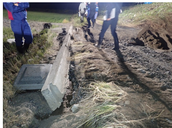
写真-5.2.4.29 川裏法尻の排水工流出状況
