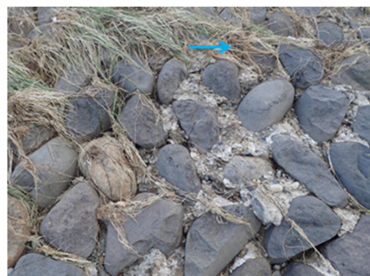
写真-5.2.1.11 欠損箇所上流護岸
