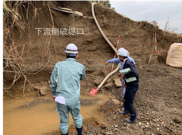
写真-5.2.3.16 堤体底面の砂礫層からの湧水
