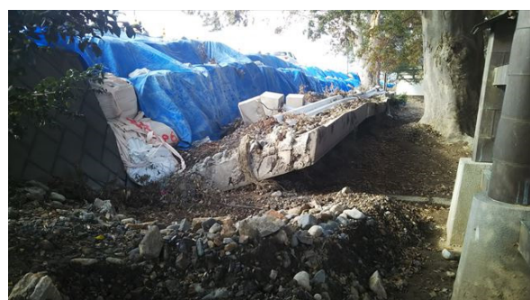
写真-5.2.13.16 千曲川左岸 79.0KP 擁壁の倒壊
