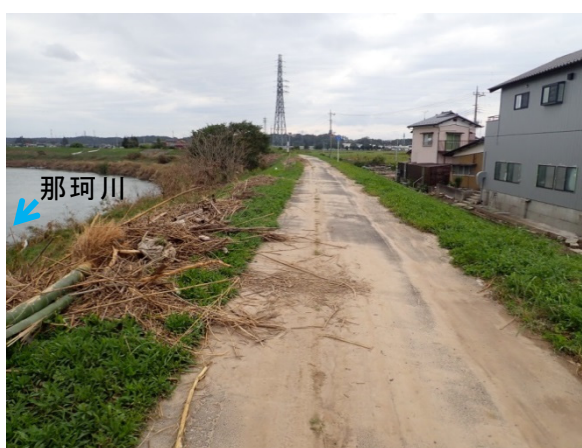
写真-5.2.7.8 堤防天端越流痕跡と漂流物
