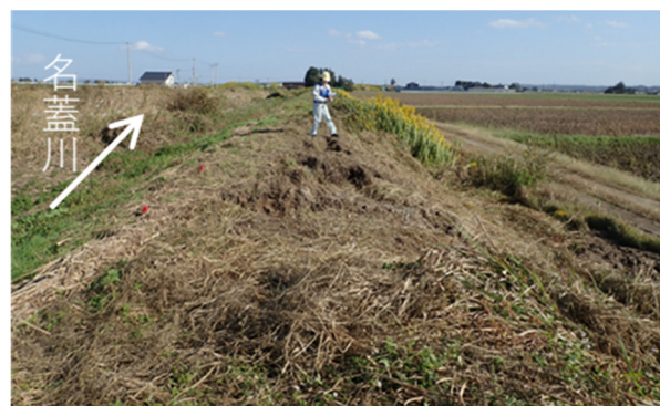
写真-5.2.12.10 名蓋川 a 地点決壊箇所堤防上から下流を望む
