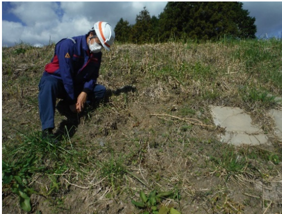
写真-5. 2. 17. 24 法肩の陥没
