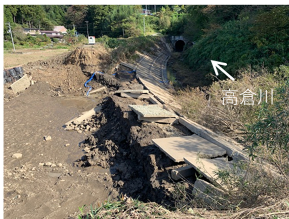
写真-5.2.12.17 高倉川左岸決壊箇所を上流側天端上から望む
