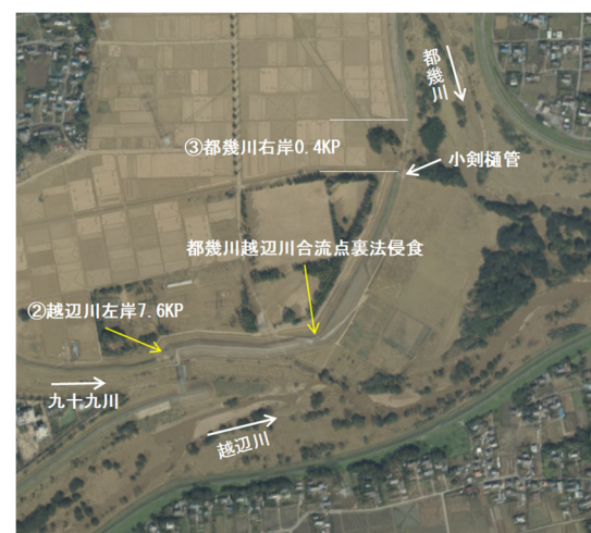
写真-5.2.3.9 越辺川都幾川合流点の 裏法侵食
