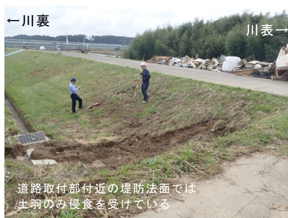
写真-5.2.7.22 道路取付部付近の被災状況 那珂川左岸19.8KP上流から
