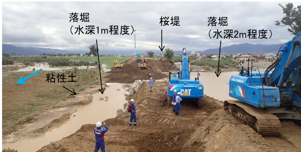
写真-5.2.1.1 決壊地点全景（下流から）
