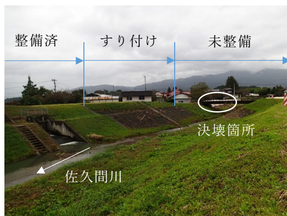
写真-5.2.5.28 佐久間川 決壊箇所と整備状況
