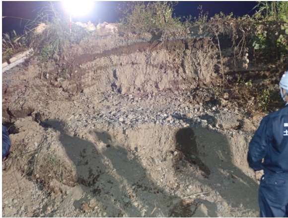
写真-5.2.4.25 決壊箇所堤防断面の観察
