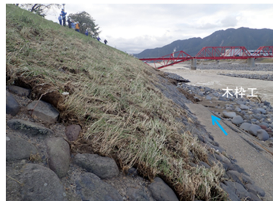
写真-5.2.1.10 欠損箇所上流護岸
