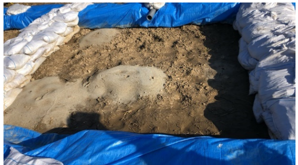
写真-5.2.18.18 阿武隈川下流左岸 18.0KP 釜段内部の噴砂その 3
