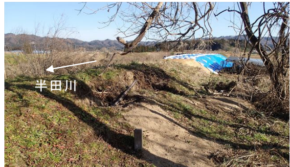
写真-5.2.19.8 半田川左岸決壊箇所
