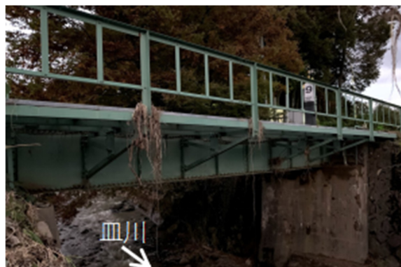
写真-5.2.9.8 決壊箇所直上流の JR 橋梁
