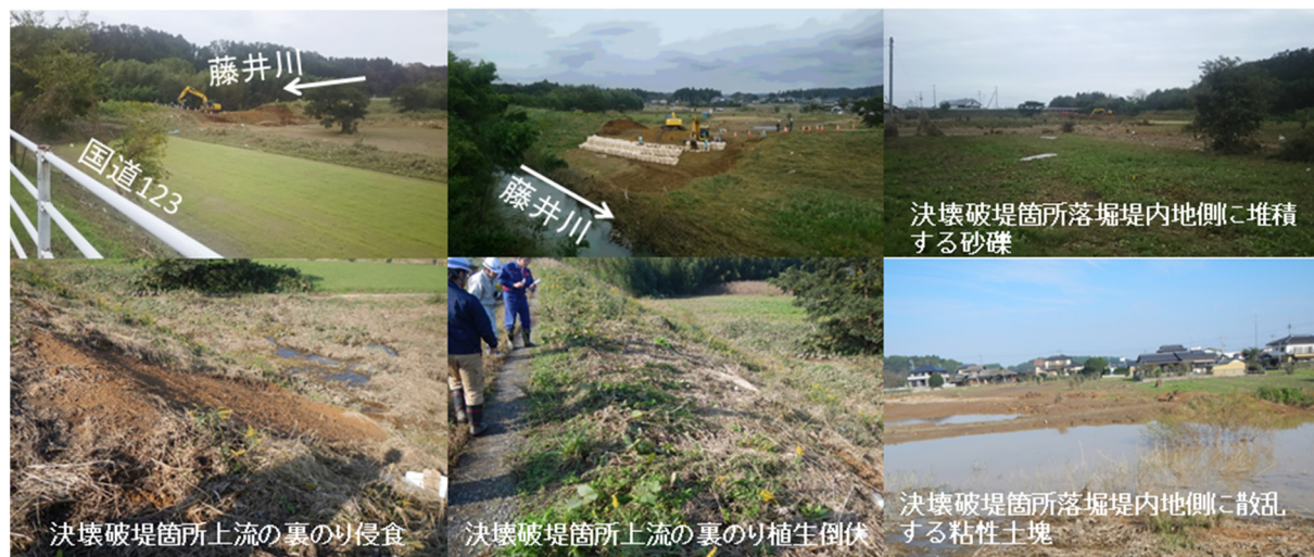
写真-5.2.14.1 藤井川左岸下流被災状況
