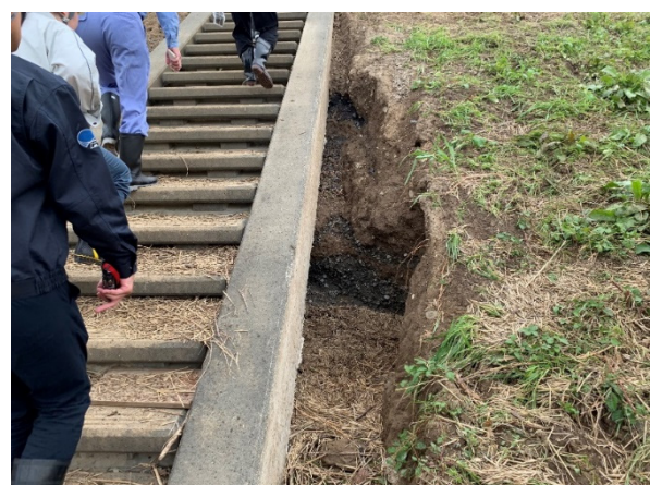
写真-5.2.3.13 小剣樋管階段脇の堤体侵食
