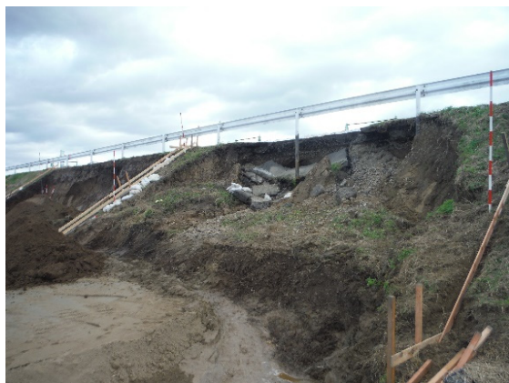
写真-5.2.17.1 阿武隈川下流左岸 17.2KP (法崩れ)
