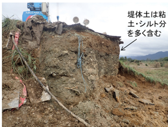
写真-5.2.1.4 決壊地点下流断面
