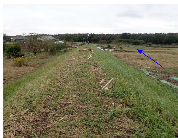
写真-5.2.4.18 堤防天端及び裏法の越流痕跡
