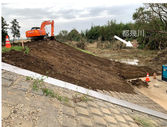
写真-5.2.3.12 残存する樋管周囲の護岸
