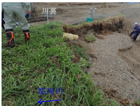
写真-5.2.4.5 決壊箇所下流部の侵食形状
