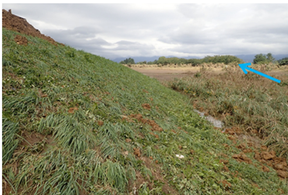
写真-5.2.1.6 決壊地点下流表法面
