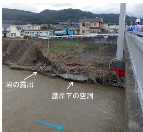
写真-5.2.1.16 上田橋左岸護岸
