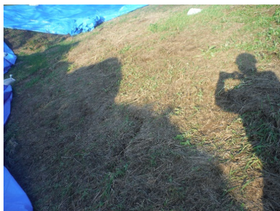
写真-5. 2. 17. 18 阿武隈川上流左岸 10. 7KP (阿武隈川上流左岸法面すべり)
