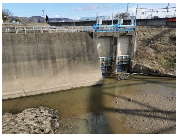
写真-5.2.19.2 高倉川に設置された水門
