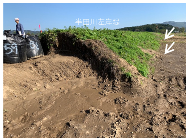
写真-5.2.12.22 決壊箇所を堤内地側から望む
