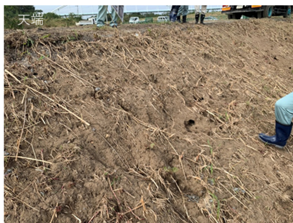
写真-5.2.3.20 侵食された裏法面
