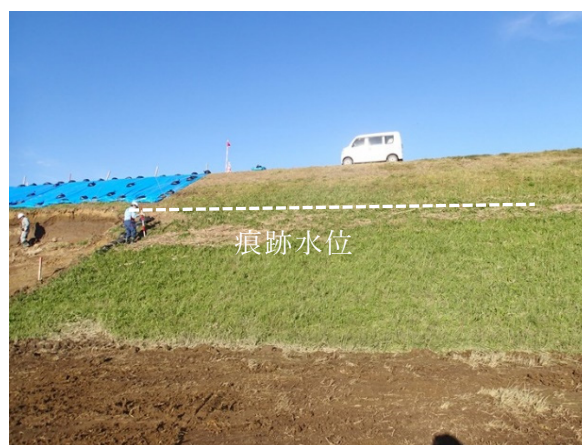
写真-5.2.5.10 鳴瀬川左岸 8.4～8.8KP 痕跡水位
