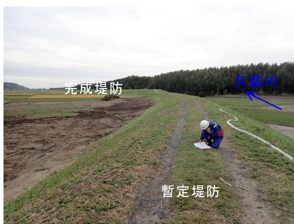
写真-5.2.4.17 決壊箇所下流天端状況
