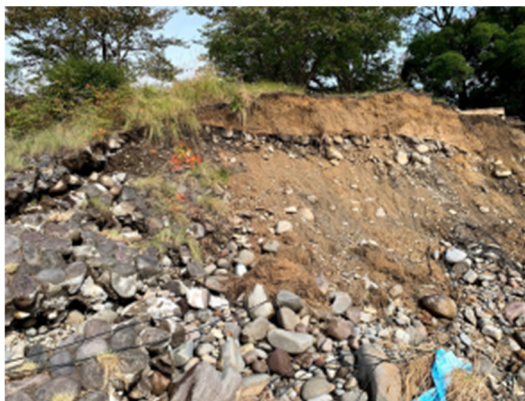
写真-5.2.9.4 侵食箇所下流端の様子
