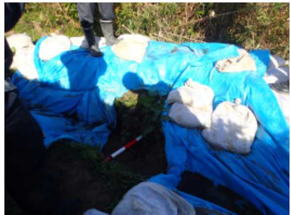
写真-5. 2. 18. 31 阿武隈川下流左岸 36. 6KP 堤脚水路脇の空洞
