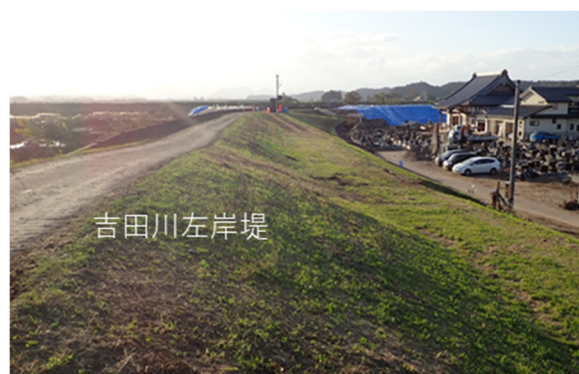
写真-5.2.12.14 下流側から決壊箇所を望む
