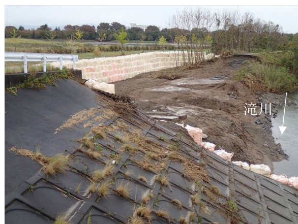
写真-5.2.5.24 滝川 決壊箇所
