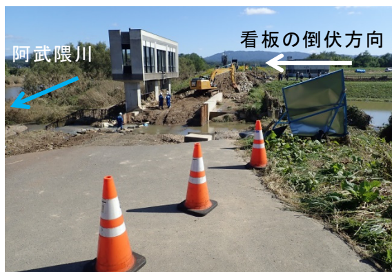
写真-5.2.2.5 堤防天端上の看板の倒伏
