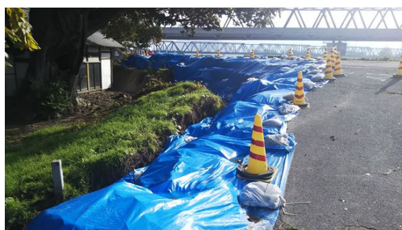
写真-5.2.13.17 千曲川左岸 79.0KP 裏法肩侵食
