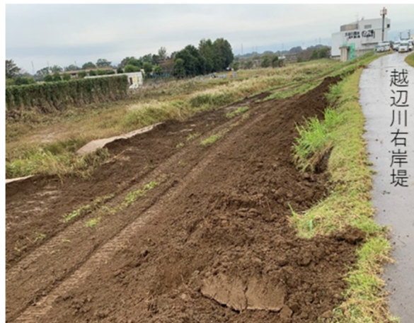
写真-5.2.3.1 決壊箇所上流の裏法侵食
