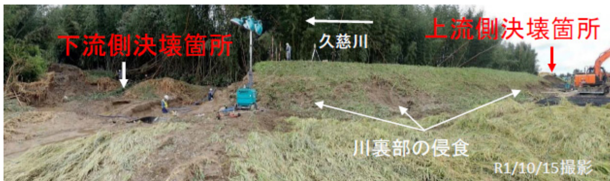
写真-5.2.4.24 被災状況（関東地方整備局 13) ）
