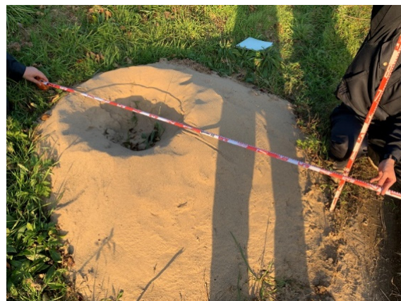
写真-5. 2. 17. 15 阿武隈川上流左岸 10. 7KP (漏水痕)
