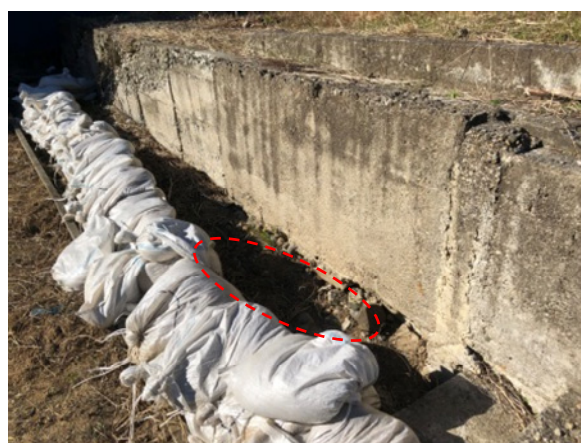
写真-5. 2. 18. 41 荒川右岸 0.2KP 腰留め擁壁の損傷
