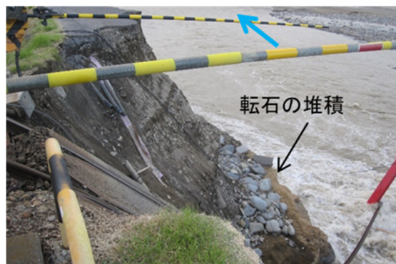
写真-5.2.1.13 上田電鉄橋梁橋台流出箇所
