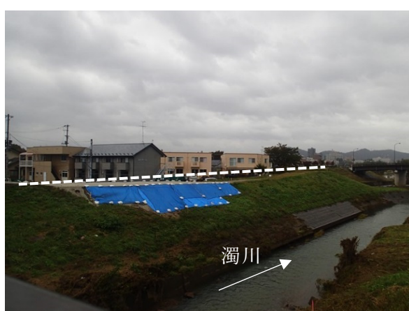
写真-5.2.5.31 濁川 決壊箇所
