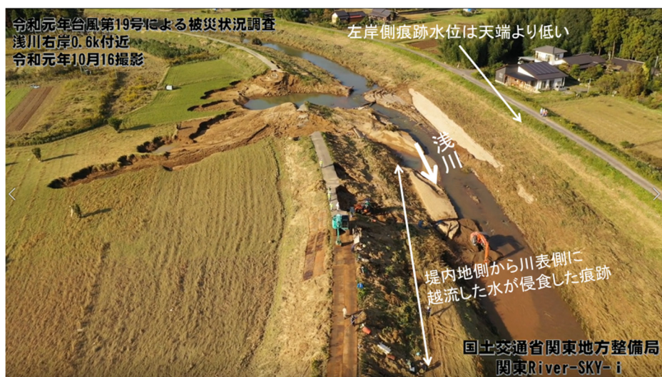
写真-5.2.6.8 応急復旧初期の被災箇所状況（関東地方整備局 16) ）
