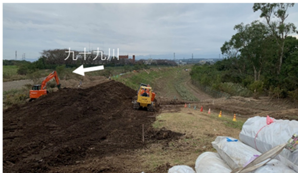
写真-5.2.3.6 決壊箇所及び上流の堤防
