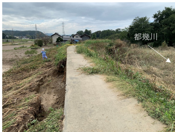
写真-5.2.3.14 決壊箇所上流側の状況
