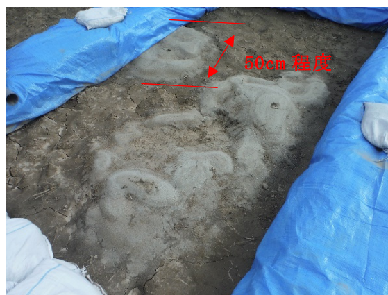
写真-5.2.17.9 阿武隈川下流左岸 18.0KP (漏水口)
