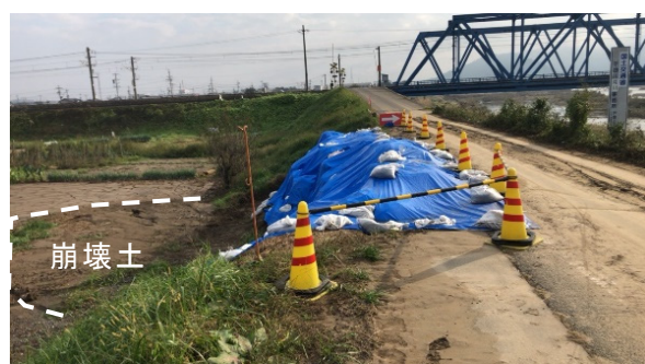
写真-5.2.13.14 千曲川左岸 79.0KP 川裏法崩れ
