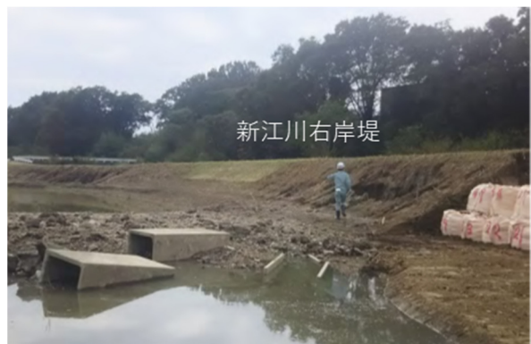
写真-5.2.3.18 決壊箇所上流側裏法面
