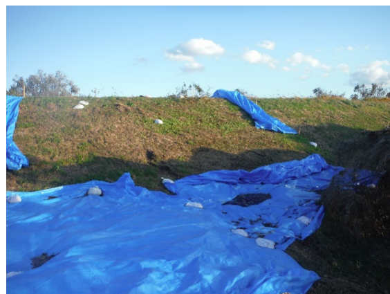
写真-5. 2. 17. 17 阿武隈川上流左岸 10. 7KP (阿武隈川左岸法面すべり)
