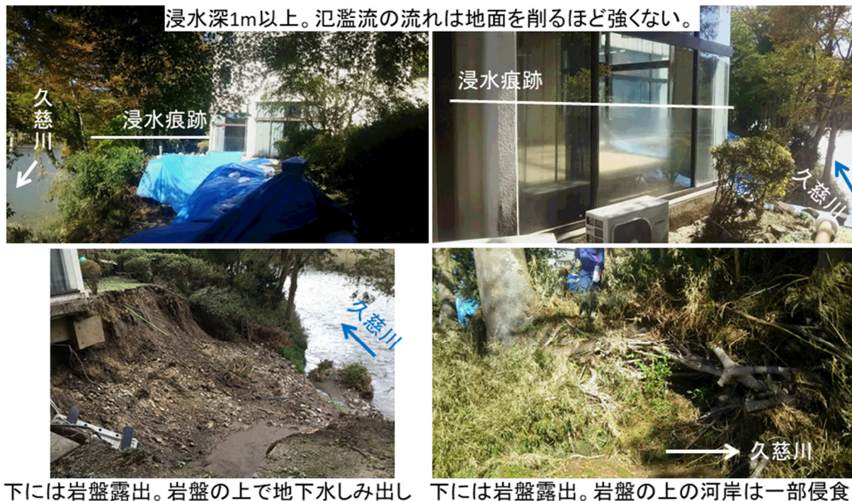
写真-5.2.6.2 調査対象箇所の河岸侵食（崩落）の状況
