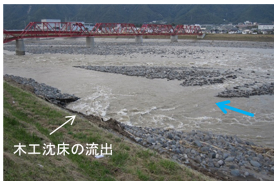
写真-5.2.1.12 欠損箇所上流木工沈床
