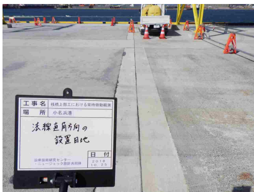
図-3.10 観測時の栈橋の状況（目地部）
