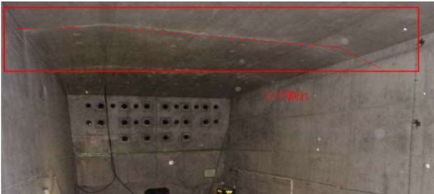
(b) ひび割れ状況
