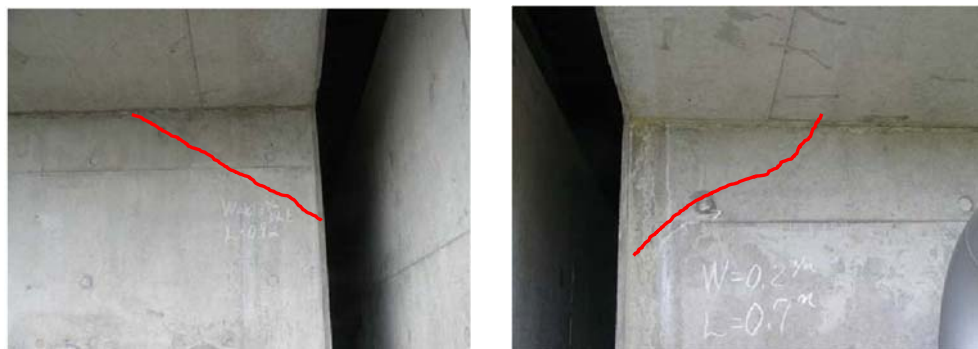
写真-3.6.1 桁端部のひび割れ事例
