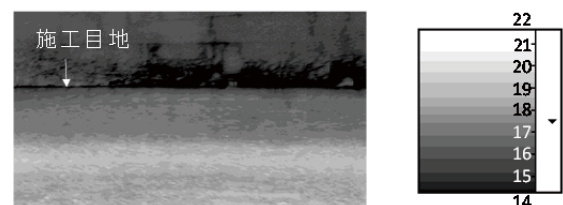
b) 施工目地部の滞水
