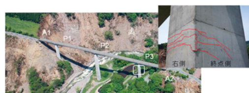
図 1 阿蘇長陽大橋 P3 橋脚の貫通ひび割れ
