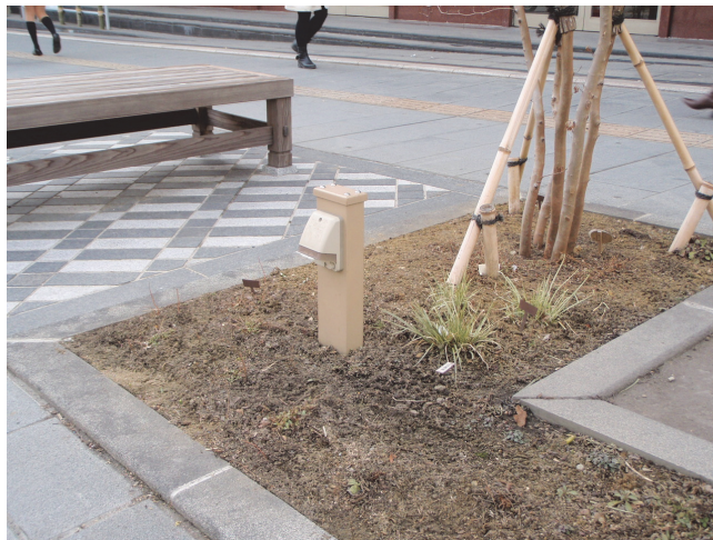
道路占用許可に基づき植樹帯内に設置された電源設備(長野県長野市 長野中央通り) 資料提供:長野市
