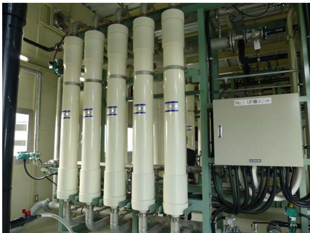
図 2-5 UF 膜ろ過装置(実証施設)の外観
