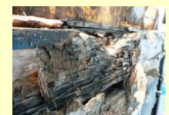
劣化したルーフバルコニー
