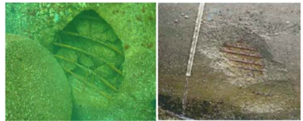
図-1 消波ブロック被覆堤における穴あき損傷(左写真)と鉄筋の露出(右写真) 2)
