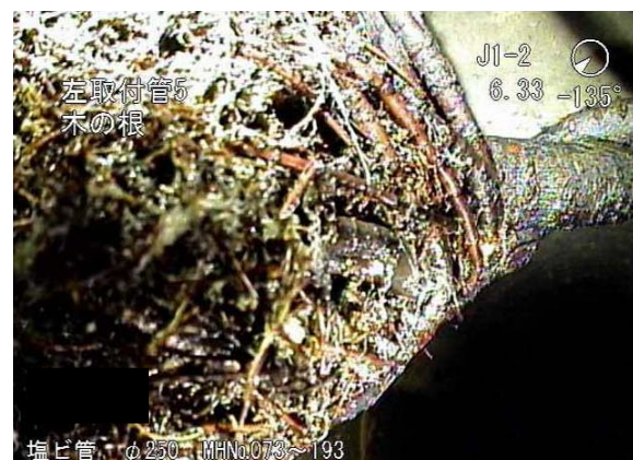
図 2-47 樹木根侵入の側視画像
