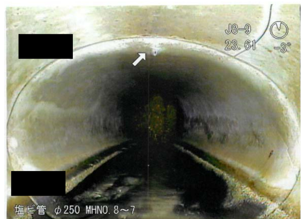
図 2-37 管径φ250：破損の直視画像
