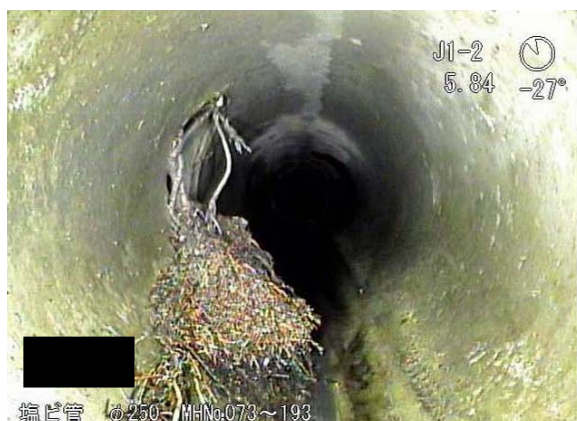
図 2-46 樹木根侵入の直視画像
