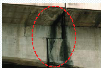
ゲルバー部のひびわれと漏水
