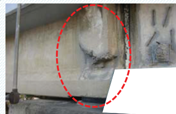
PC鋼材定着部のコンクリートの剥離と鋼材の露出
