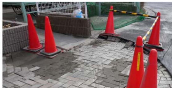
写真 2.3-2 周辺地盤の液状化の様相
